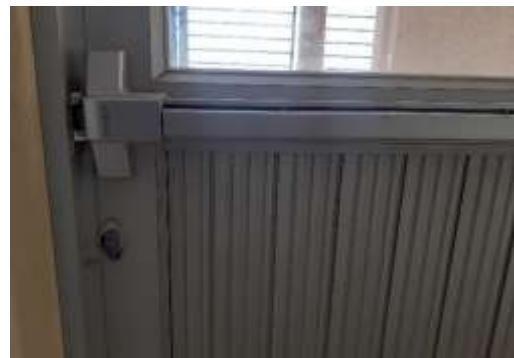
Imagen 16. Puerta de emergencia.
