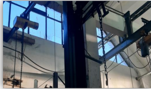
Fotografía 8. Presencia de polvo en ventanas de las instalaciones
