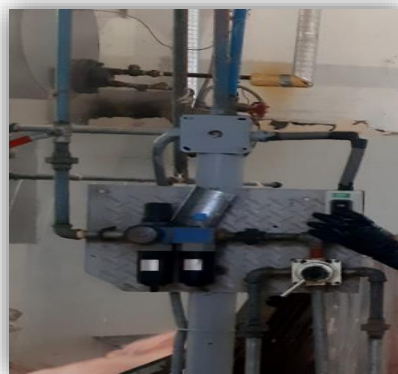
Fotografía 6. No se presenta rotulación en base a alguna normativa tecnica.
