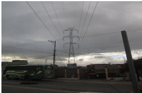
Servicio electrico (Z-13)
