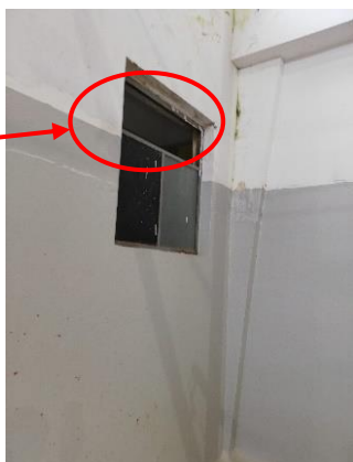
Fotografía 3. Ventanas de planta de faenado sin vidrios
