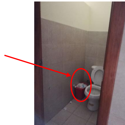
Fotografía 12. Acumulación de basura en los servicios higiénicos del personal
