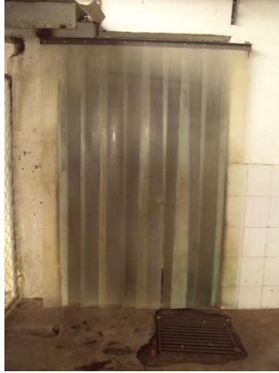
Fotografía 7. Persianas plásticas del cuarto de oreo desgastadas y con presencia de suciedad
