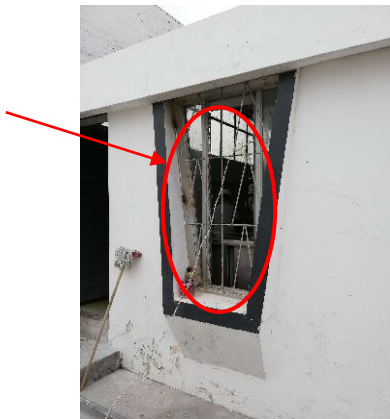
Fotografía 9. Ventana de área de lavado de vísceras blancas no cuenta vidrio
