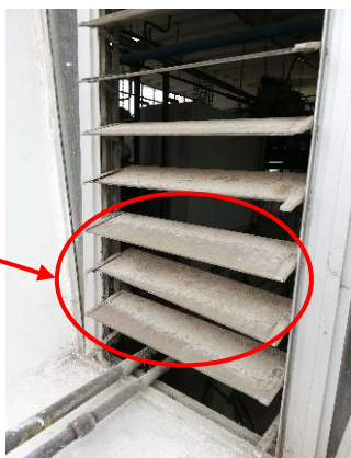
Fotografía 5. Ventanas superiores de la planta con presencia de polvo
