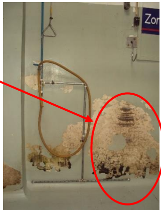
Fotografía 1. Paredes y pisos de planta en mal estado y con presencia de moho
