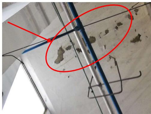
Fotografía 6. Pintura de techo de planta descascarada
