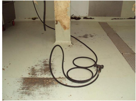
Fotografía 14. Falta de orden en el cuarto de oreo
