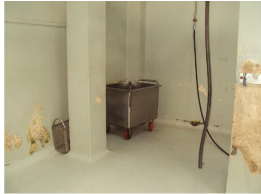
Fotografía 8. Pintura de paredes del cuarto de oreo en mal estado
