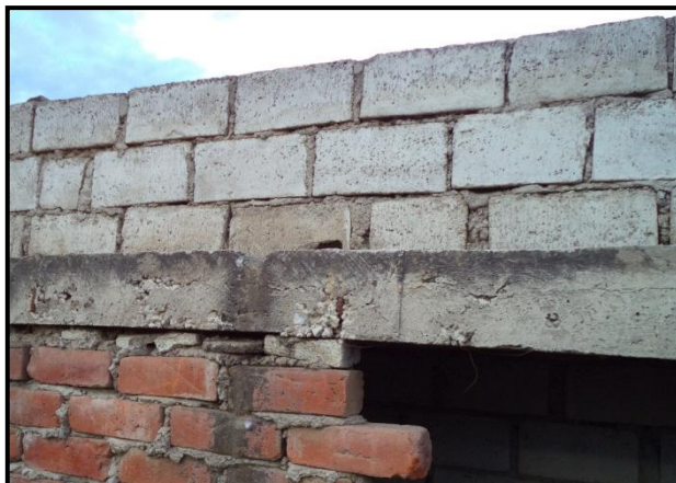
Hormiguno, acero sin recubrimiento y separación entre mampostería –viga.
