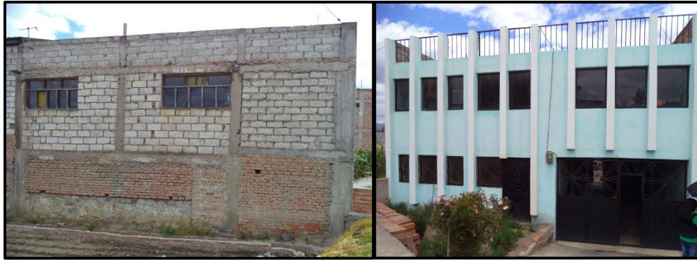
Figura 17. Piso débil por la falta de continuidad de los elementos estructurales. Barrio La Libertad
