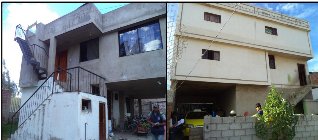
Figura 16. Viviendas con discontinuidad de resistencia y rigidez en el primer piso. Barrio La Libertad
