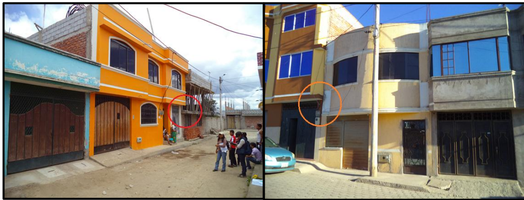
Figura 19. Viviendas con problemas de colindancia, golpeteo por desnivel de losas. Barrio La Libertad
