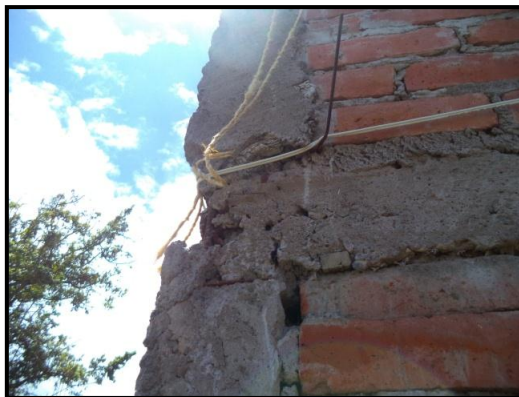
Figura 44. Conexión deficiente entre viga y columna, vivienda D_13_2P, columna A4.
