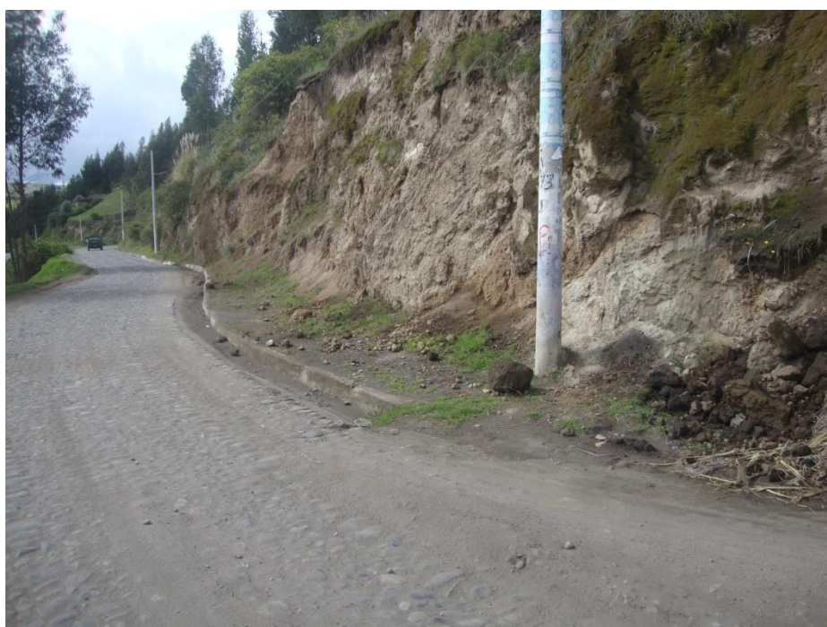
SOCAVACION DE LA MESA ABSCISA 6+900
