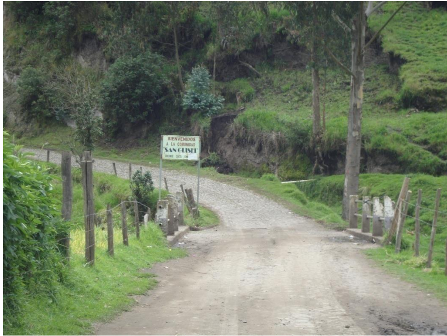
ESTADO ACTUAL DEL PUENTE ABSCISA 2+780
