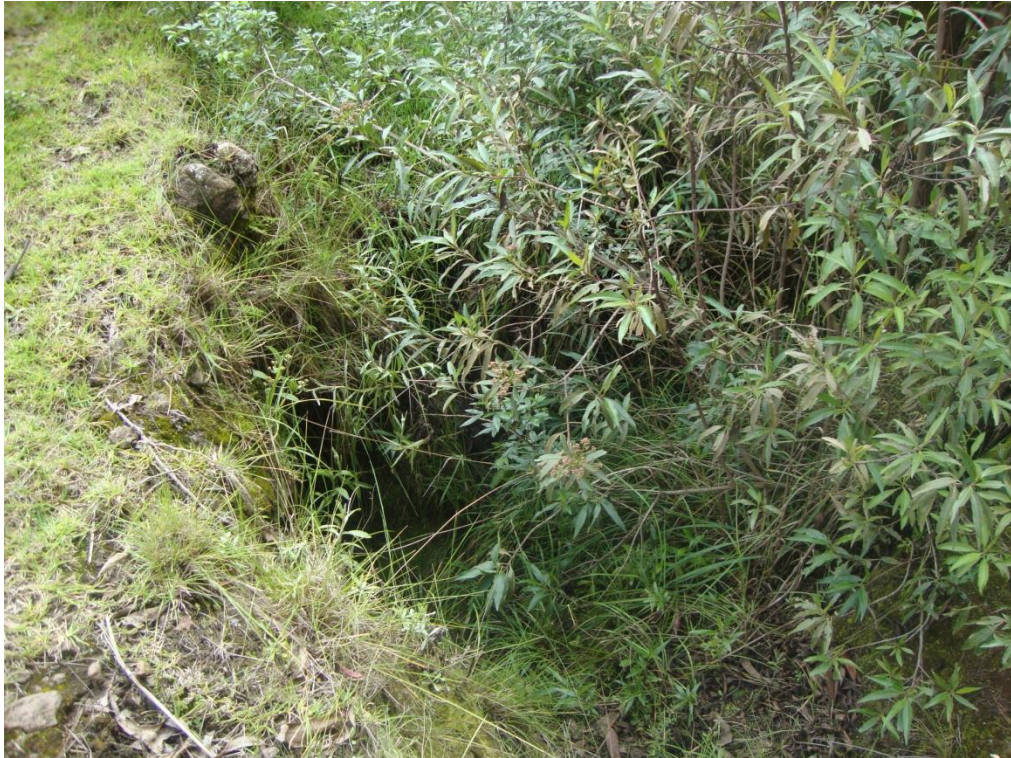
ALCANTARILLA SIN PROTECCIÓN DE ENTRADA Y SALIDA ABSCISA 1+050
