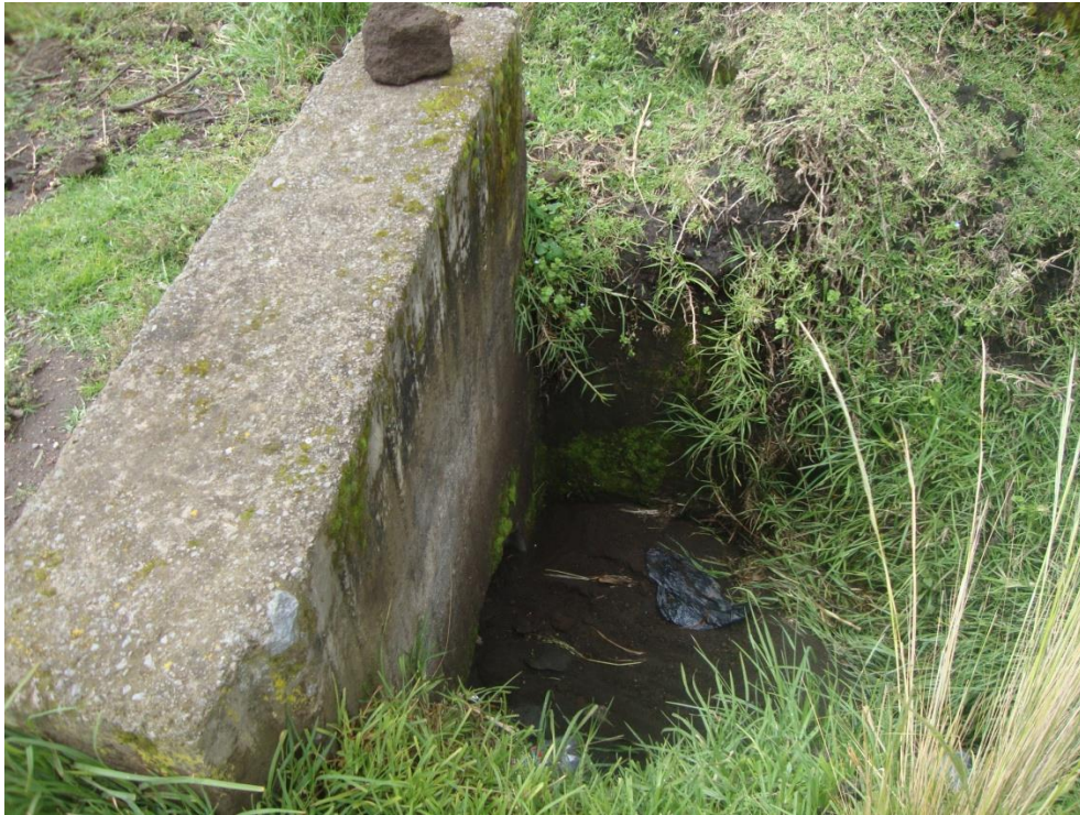
ALCANTARILLA OBSTACULIZADA POR BASURAS Y VEGETACIÓN ABSCISA 3+480
