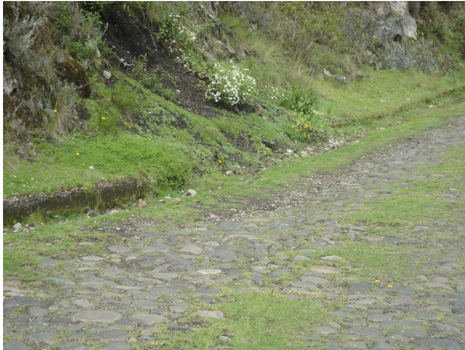
BACHES EN LA CALZADA ABSCISA 0+500
