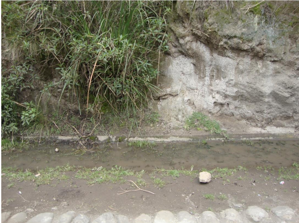
DESLIZAMIENTO DE LA MESA ABSCISA 3+100 (LIMPIEZA DE CUNETAS)
