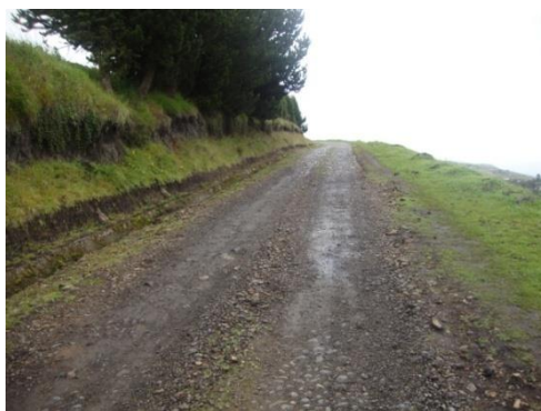
Fotografía 20: Baches y reposición de material en la calzada. Junio 2010 Lirio Pichiloma Yavirac.
