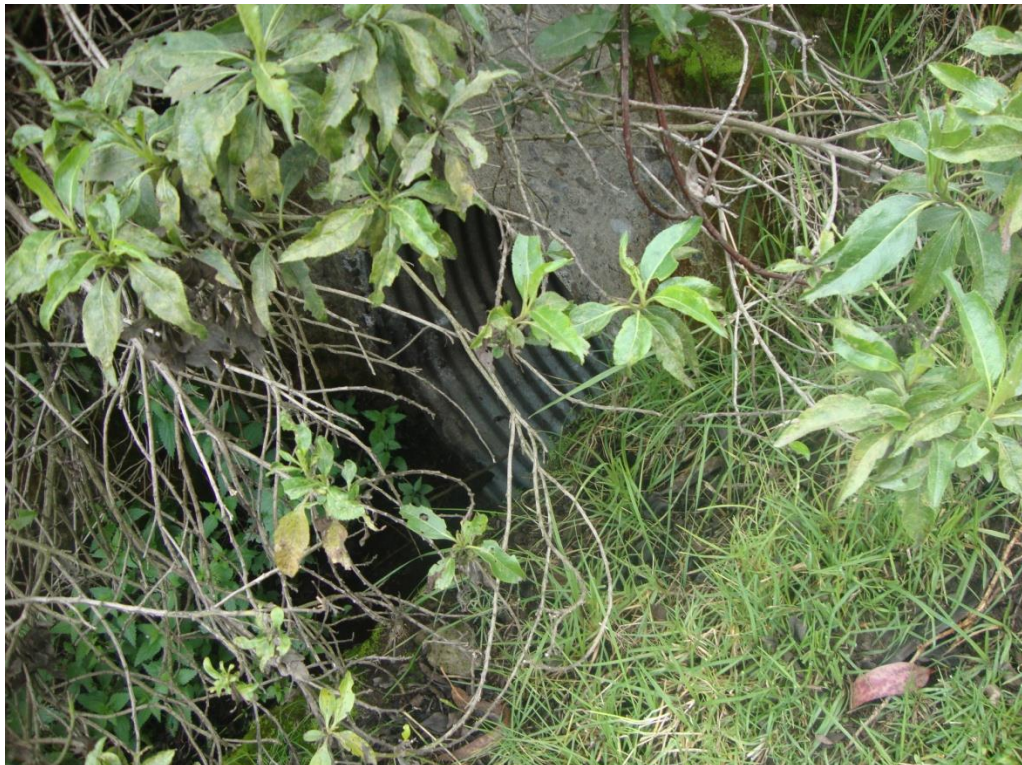
ALCANTARILLA OBSTACULIZADA POR LA VEGETACIÓN DEL SECTOR ABSCISA 0+900
