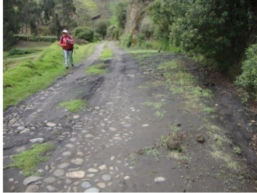
Fotografía 10: Cuneta Obstruida por deslizamiento de suelo natural Castug Tungurahuilla-Chacabamba.
