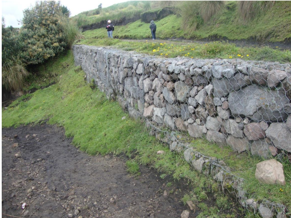
MURO GAVION DE PIEDRA ABSCISA 9+080
