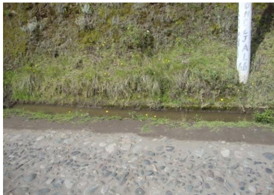
Fotografía 9: Cuneta Obstruida por Agua Lluvia Columbe – San Guissel
