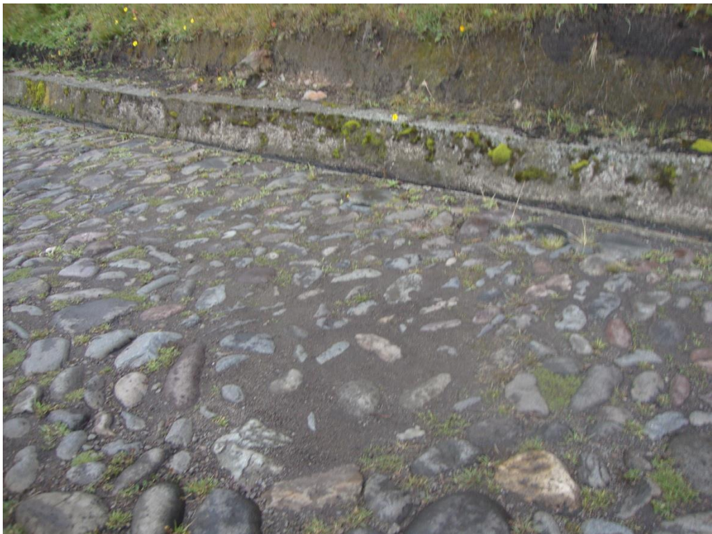
CALZADA DAÑADA BACHES ABSCISA 0+520
