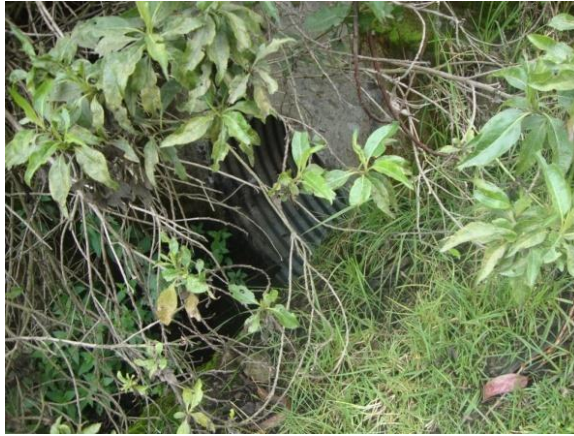
Fotografía 13: Alcantarilla tapada por la vegetación del sector Castug Tungurahuilla – Chacabamba.
