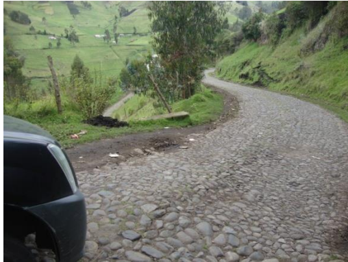
Fotografía 18: Baches en la calzada. Febrero 2010 Columbe San Guissel
