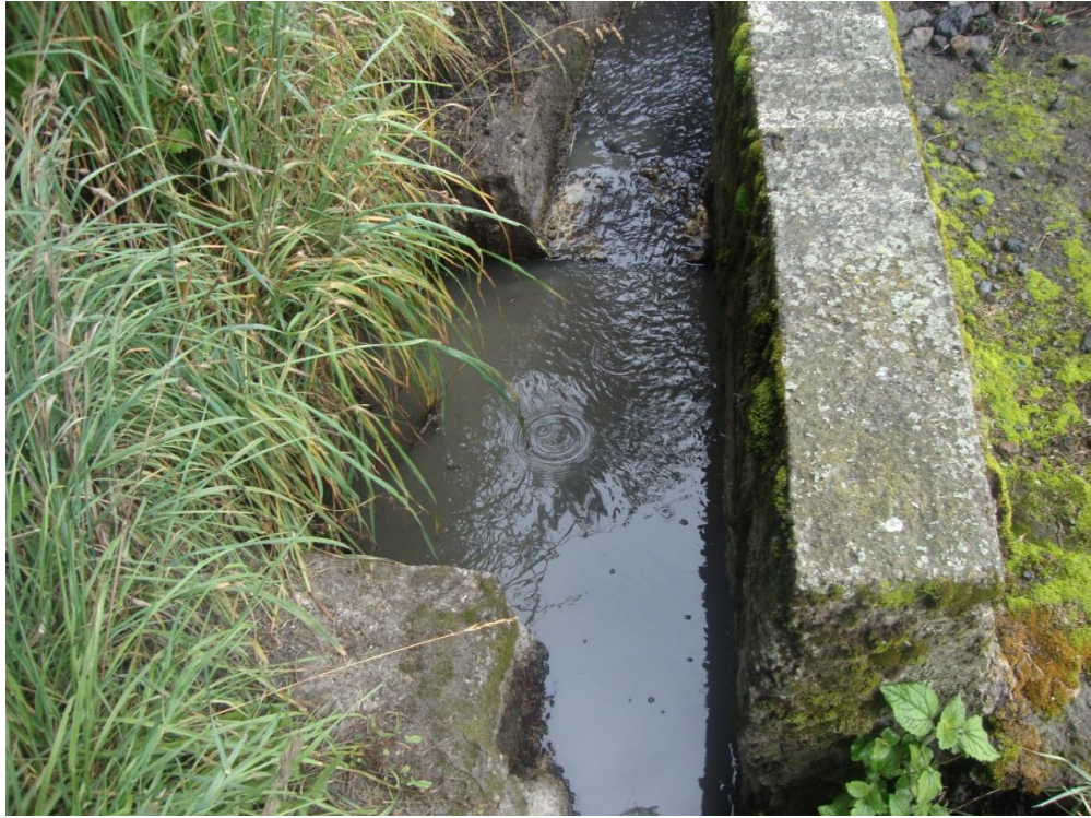
ALCANTARILLA SEMI TAPADA ABSCISA 0+130
