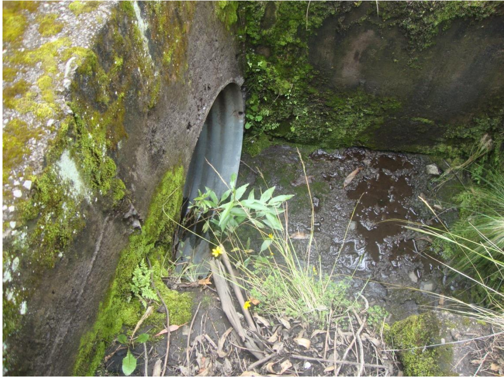
ALCANTARILLA CON ESTRUCTURA DE ENTRADA Y SALIDA PARCIALMENTE TAPADA
