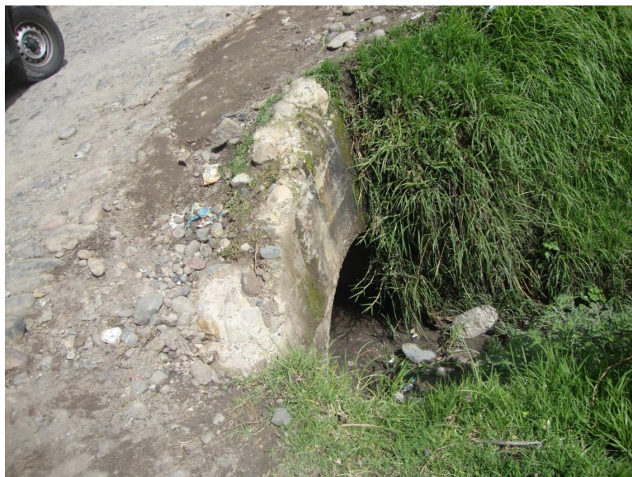
ALCANTARILLA ABSCISA 0+610 – ENTRADA TAPADA (SALIDA TAPADA POR SEDIMENTOS - BASURA)
