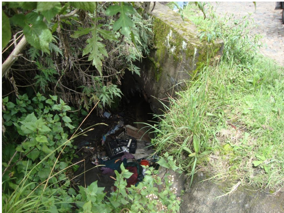
ALCANTARILLA ABSCISA 1+440 ENTRADA TAPADA
