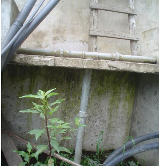
Fotografía 63. Tubería de Hg. Enero/2010
