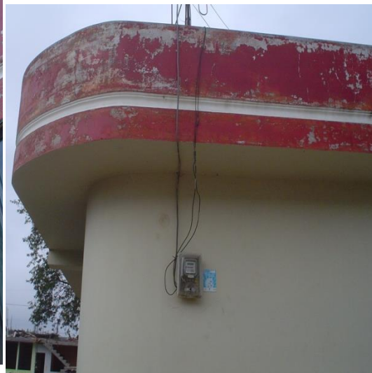
Fotografía 36. Vista lateral Desprendimiento de pintura Enero/2010
