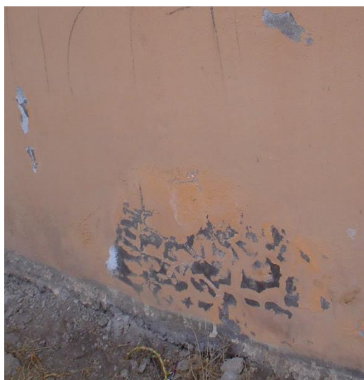
Fotografía 49. Humedad en paredes. Enero/2010
