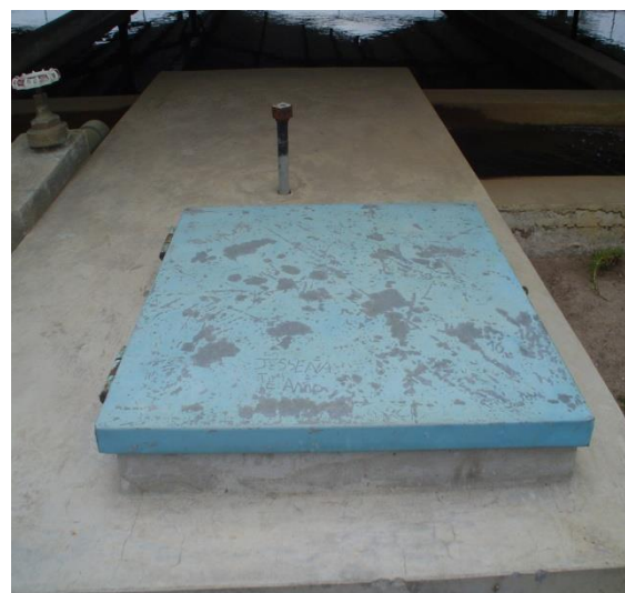
Fotografía 80. Tapa sanitaria. Enero/2010
