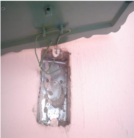
Fotografía 13. Instalaciones eléctricas incompletas Enero/2010
