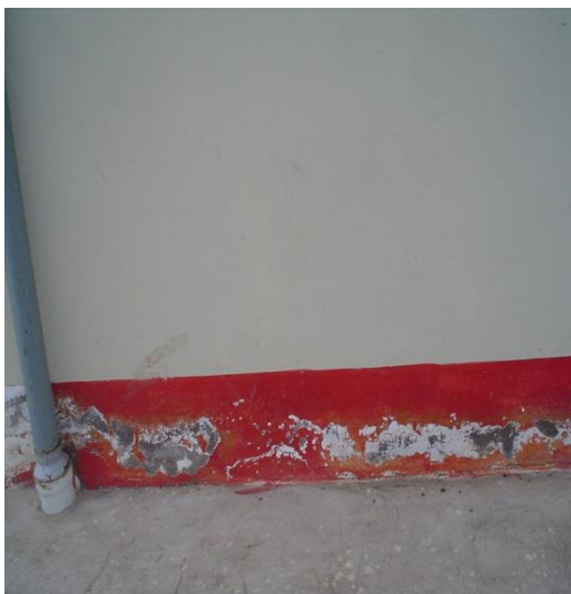
Fotografía 37. Humedad en Mampostería. Enero/2010
