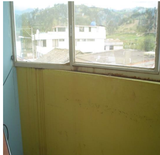
Fotografía46. Filtraciones por marcos de ventana. Enero/2010
