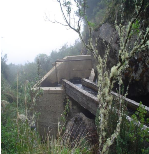
Fotografía 84. Tanque de captación. Enero/2010
