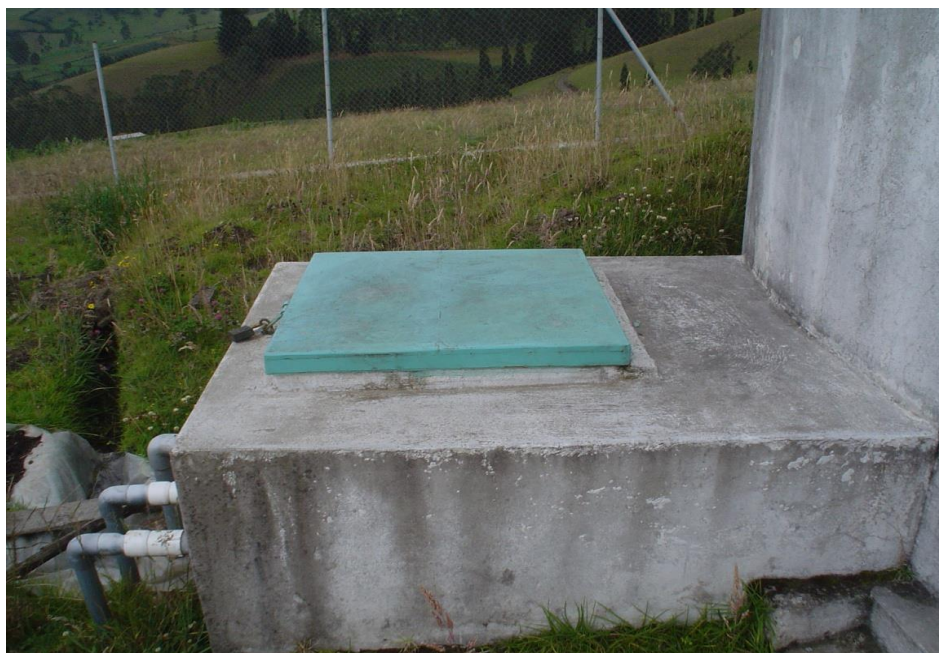
Fotografía 83. Vegetación alrededor del tanque y tubería. Enero/2010
