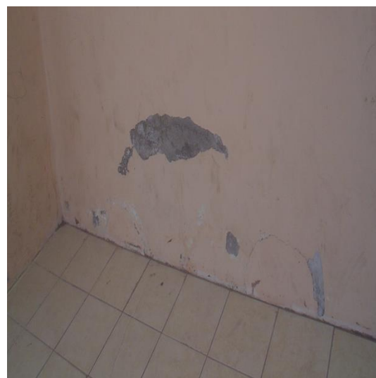
Fotografía 42. Humedad en paredes. Enero/2010
