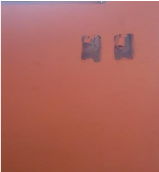
Fotografía 9. Instalaciones eléctricas incompletas Enero/2010
