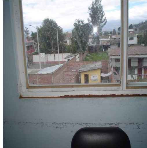
Fotografía44. Oxido en marcos de ventana. Enero/2010
