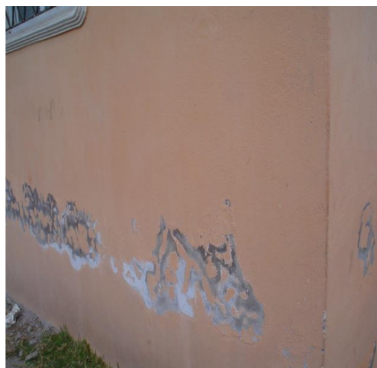
Fotografía 50. Humedad en paredes. Enero/2010
