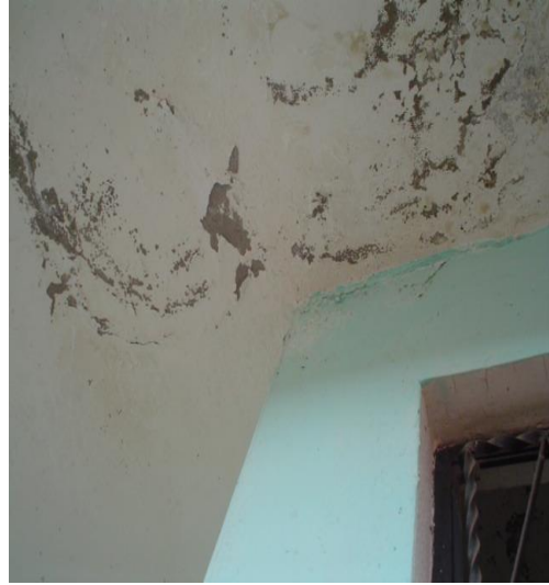
Fotografía 4. Humedad en losa batería sanitaria. Enero/2010
