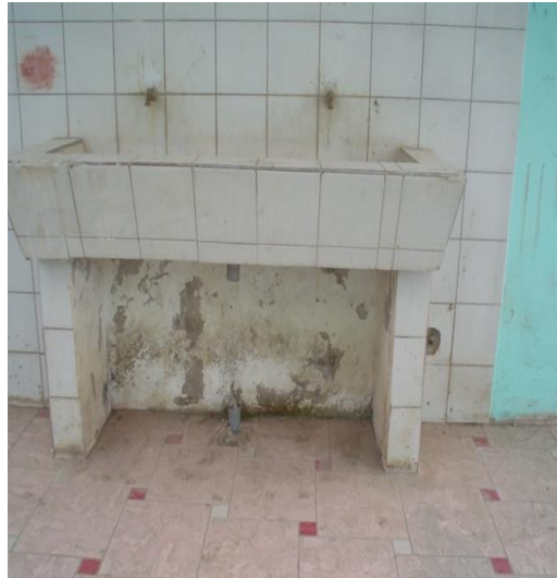
Fotografía 6. Lavamanos batería sanitaria. Enero/2010
