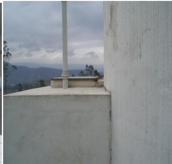
Fotografía 76. Tapa Sanitaria. Enero/2010
