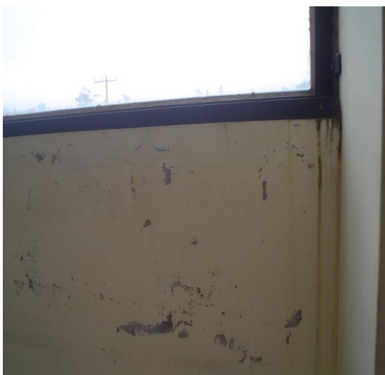
Fotografía 53. Desprendimiento de pintura. Enero/2010
