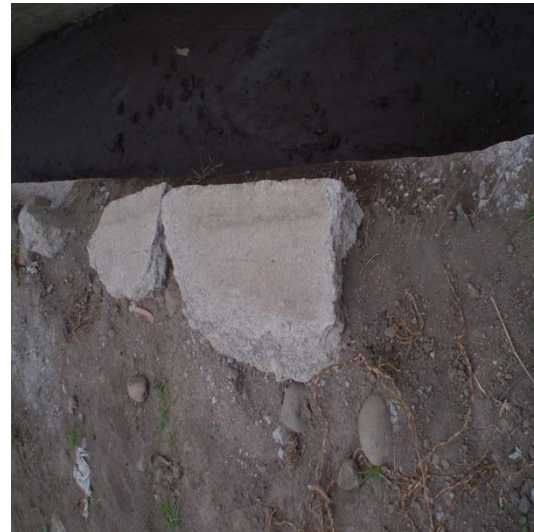
Fotografía 109. Rotura de Revestimiento. Enero/2010
