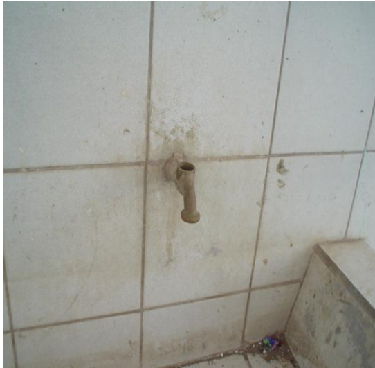
Fotografía 5. Grifos batería sanitaria. Enero/2010
