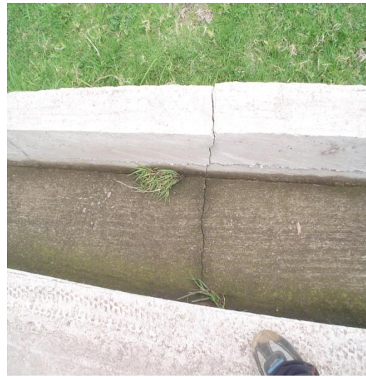
Fotografía 99. Fisurado Revestimiento. Enero/2010
