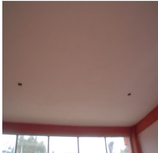
Fotografía 14. Iluminación incompleta Enero/2010
