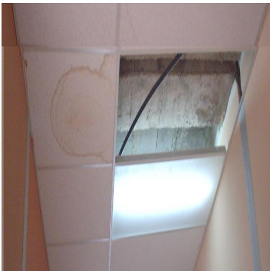
Fotografía 39. Filtraciones en cielo raso Enero/2010
