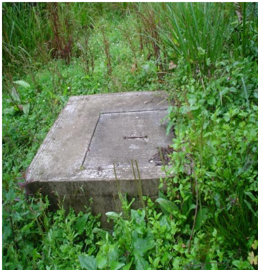
Fotografía 71. Tanque rompe presión. Enero/2009
