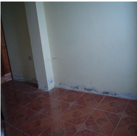
Fotografía 57. Humedad en pared. Enero/2010
