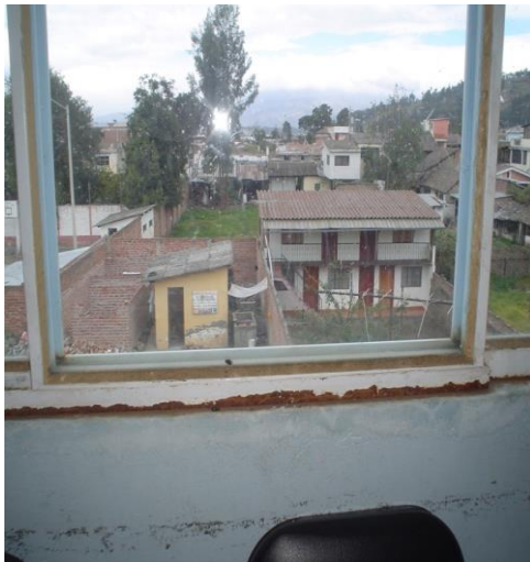
Fotografía45. Oxido en ventanas de hierro. Enero/2010
