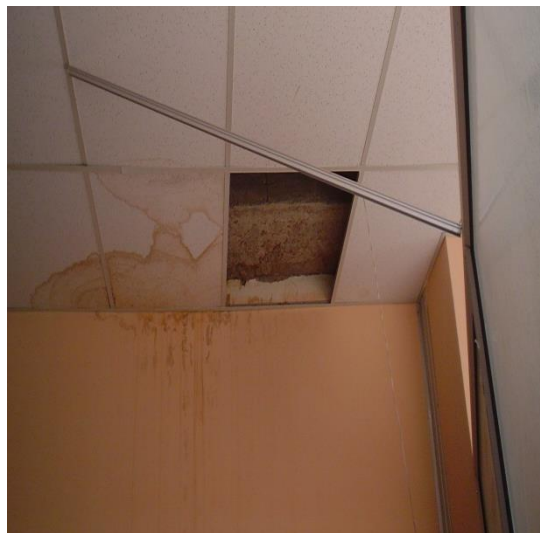
Fotografía 40. Humedad en cielo raso. Enero/2010
