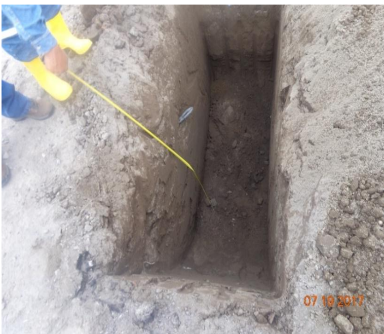
Fotografía N.3.6. Zanja mayor a 1.5m de profundidad.
