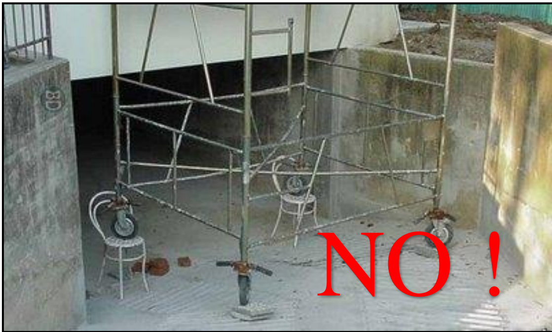
Gráfico 3.40 Inadecuada forma de colocación de andamios
