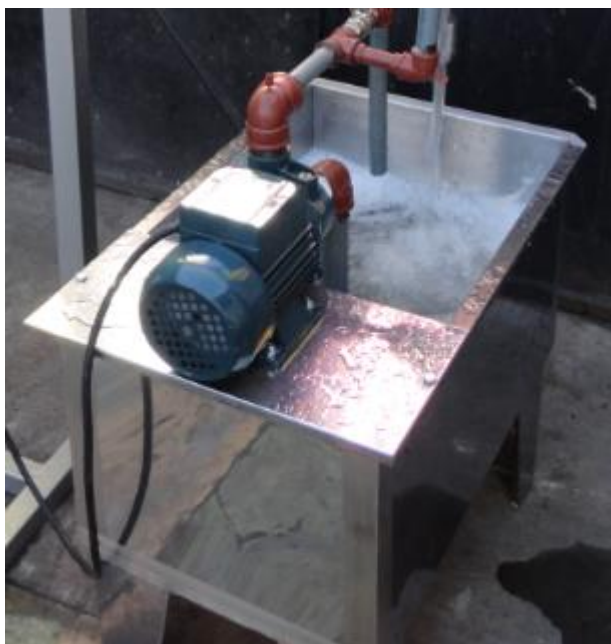
Figura 27. Tanque de almacenamiento y bomba centrífuga
