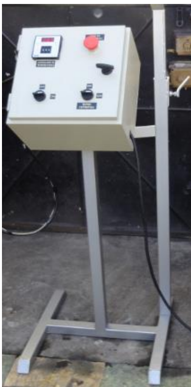
Figura 26. Soporte y panel de control
