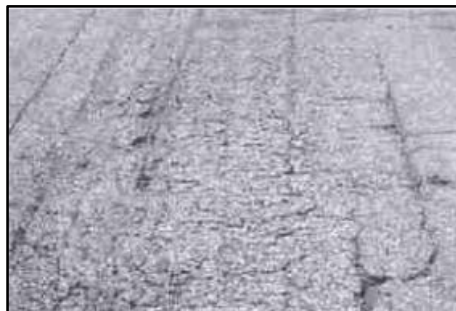
Ilustración 22. Intemperismo en la vía.
