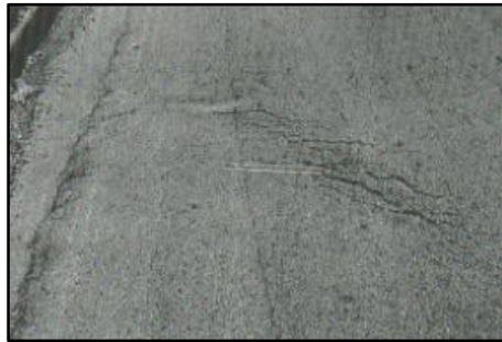
Ilustración 20. Fisuramiento de Resbalamiento.
