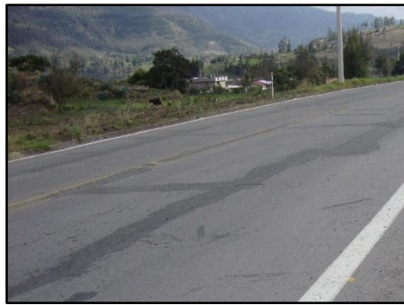
Ilustración 14. Parches en el pavimento flexible. Fuente: Nataly F. Chinchí A, vía Riobamba-Penipe, 2016.
