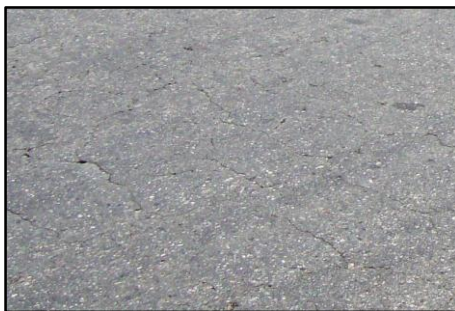
Ilustración 6. Fisuras en bloque.
