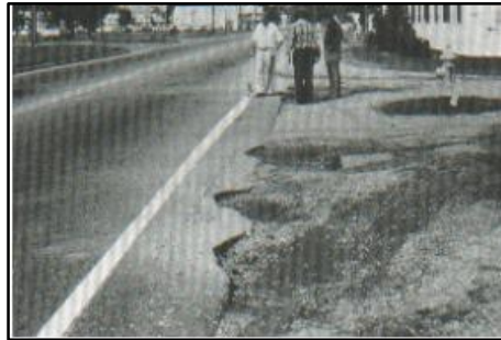
Ilustración 10. Fisuramiento en borde.
