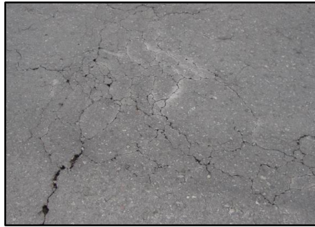
Ilustración 4. Falla piel de cocodrilo
