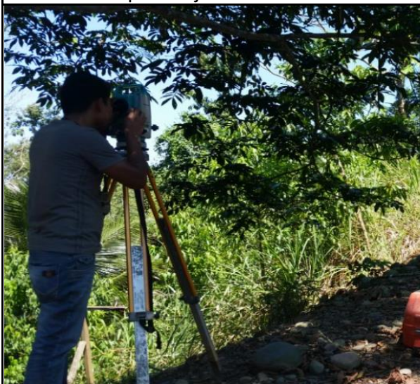
Cambio de estación captación
