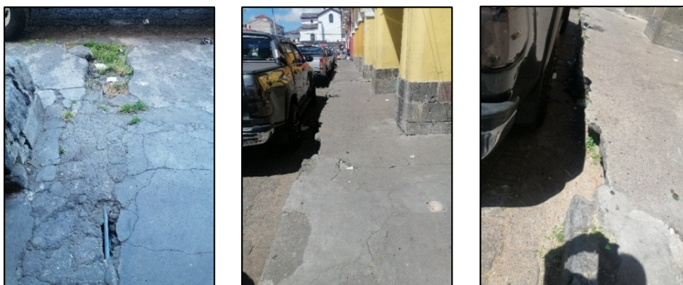
Estado de los pisos de los portales de la plaza “César Chiriboga”
