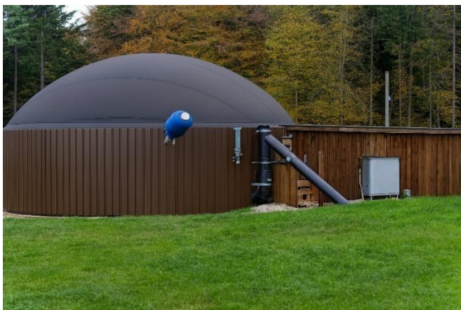
Figura 5. Biodigestor con tanque de almacenamiento tradicional y cúpula de polietileno.
