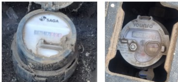
Figura 8. Marcas de medidores que se encuentran en la cabecera Parroquial de Licto.
