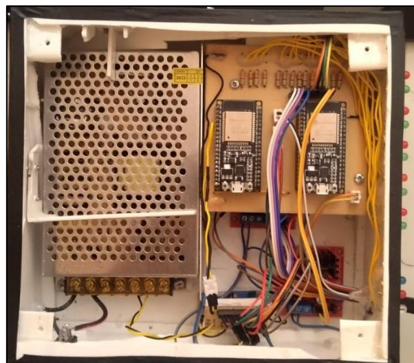
Figura 30: Implementación del Sistema Electrónico. Fuente: Autor.
