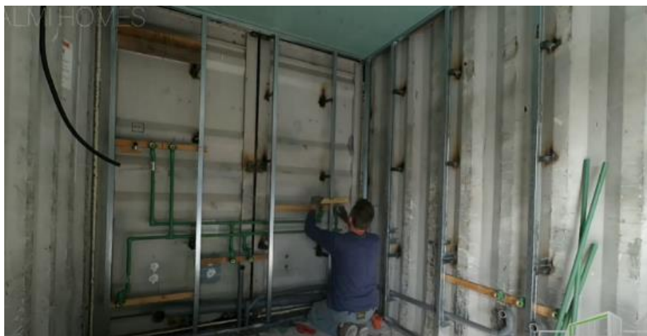
Figura 19. Instalaciones Dentro de un Contenedor
