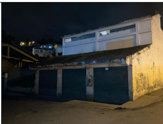
Foto 4: Deterioro de Cubiertas
