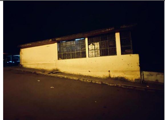
Foto 8: Daños en ventana y cubierta
