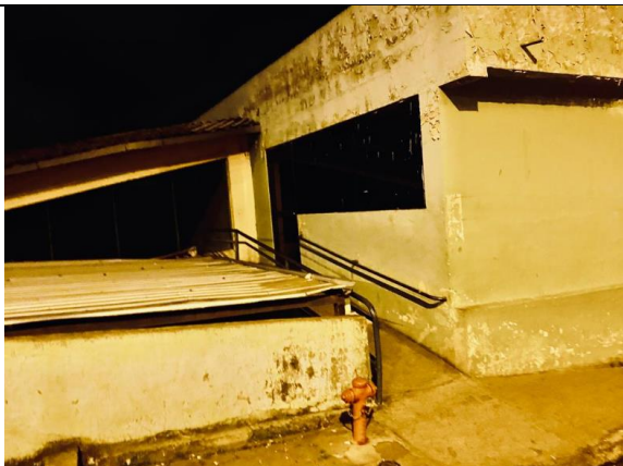
Foto 9: Deterioro en fachada
