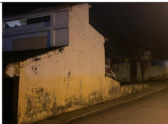
Foto 3: Deterioro de Fachadas
