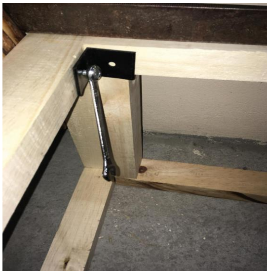
Figura 40: Platinas y pernos en uniones de escalerillas.
