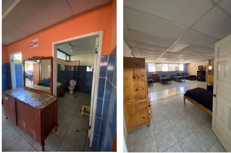
Ilustración 32 Ingreso de los baños dentro de las habitaciones, habitación con mobiliario en circulación.
