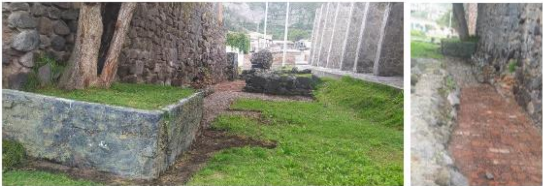
Ilustración 61. Daños por naturaleza. Fuente: (Mena Albarracín, 2022)
