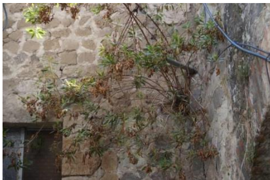
Figura 61. Presencia de plantas en esquinas de la iglesia Fuente: Elaboración propia
