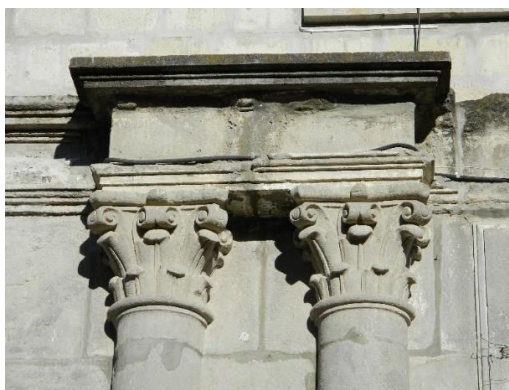
Figura 59. Vista de relleno de cemento de la cornisa en la fachada principal Fuente: Elaboración propia
