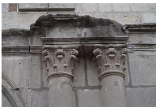
Figura 60. Vista del deterioro de la cornisa en la fachada principal Fuente: Elaboración propia
