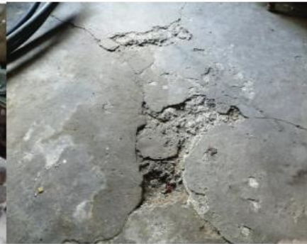
Ilustración 166.- Pisos cuarteados (causados despues de la erupción del volcán Tungurahua), estudio de vivienda-Caso 2 Fuente:Por testistas
