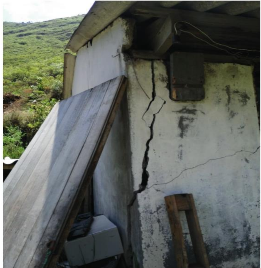
Ilustración 149.- Fachada frontal (daños que causó la erupción del volcán Tungurahua)-Caso 1 Fuente:Por tesisistas
