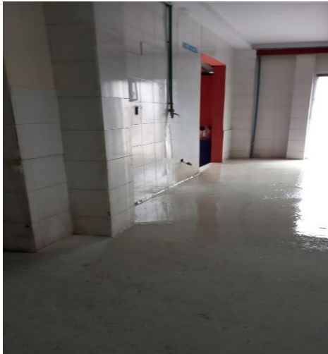
Figura 32 Fuga de agua CF "D"
