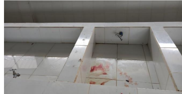
Figura 21 Después de la limpieza
