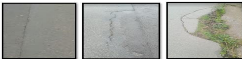
Figura 29: Falla tipo grieta de borde severidad baja, media, alta.
