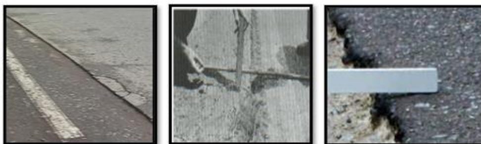
Figura 9: Falla tipo desnivel carril/berma severidad baja, media, alta.
