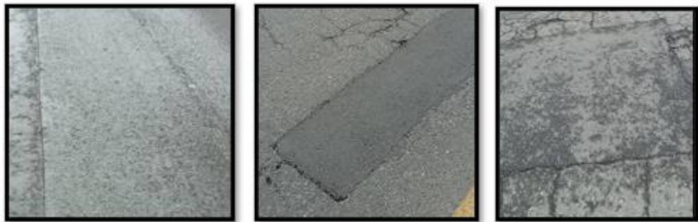
Figura 33: Falla tipo parcheo de acometidas de servicio públicos de severidad baja, media, alta
