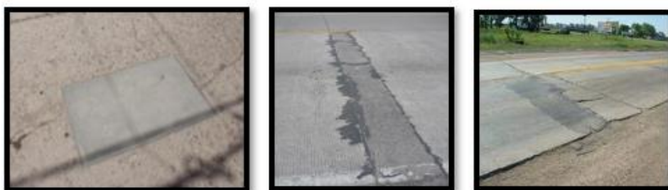
Figura 11: Falla tipo parche grande severidad baja, media y alta.
