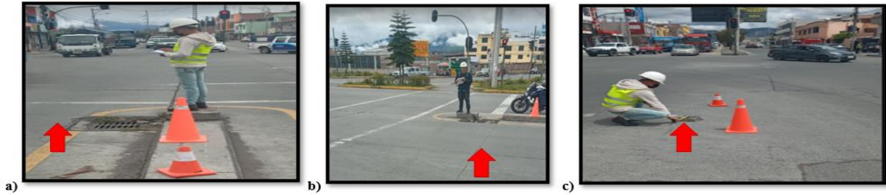
Figura 106: Vía colectora Anillo Vial (Mercado Mayorista - Entrada a San Luis) con diferentes fallas: a,b) Sello de Junta de severidad baja, c) Punzonamiento de severidad baja.
