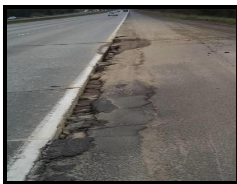
Figura 15: Falla por bombeo
