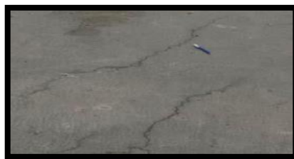
Figura 19: Falla tipo grietas de contracción o retracción
