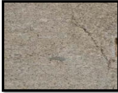
Figura 13: Falla tipo pulimientos de agregados
