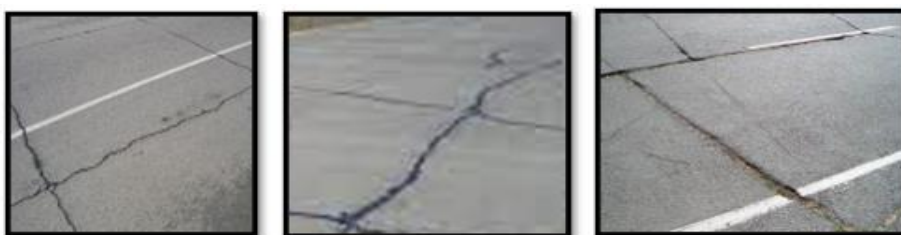
Figura 30: Falla tipo grieta de reflexión de junta de severidad baja, media, alta.
