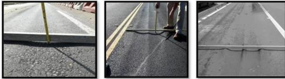
Figura 37: Falla tipo ahuellamiento de severidad baja, media, alta Fuente: (Vásquez, 2002)
