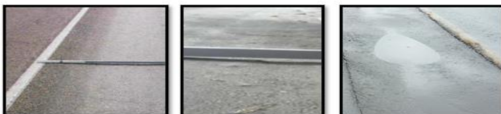
Figura 28: Falla tipo depresión de severidad baja, media, alta. Fuente: (Chauca & Pomatoca, 2022)
