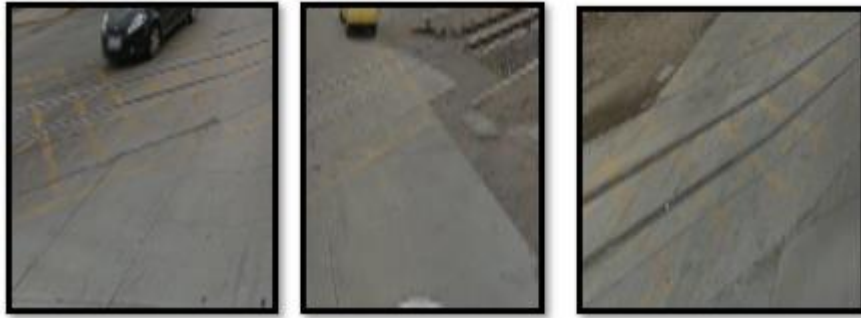
Figura 17: Falla tipo cruce de vía férrea severidad baja, media, alta.
