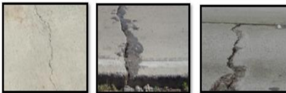
Figura 6: Falla tipo grieta de durabilidad "D" de severidad baja, media, alta.
