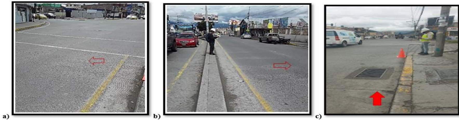
Figura 108: Vía colectora Anillo Vial (Rieles de tren – Bai Paz) con diferentes fallas: a,b,c ) Sello de Junta de severidad baja
