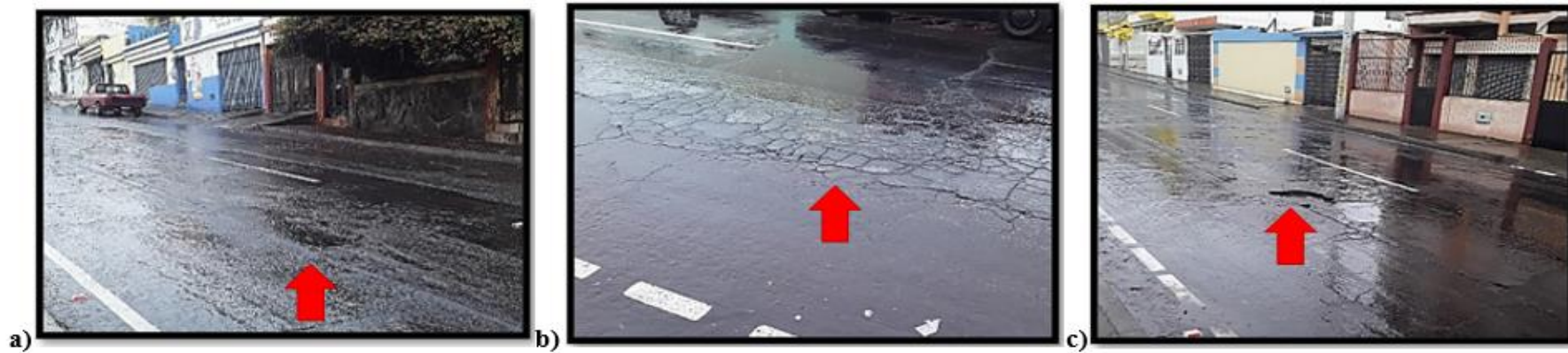
Figura 102: Vía colectora José Orozco con diferentes fallas, a) Hundimiento severidad baja, b) Agrietamiento en bloque y piel de cocodrilo severidad alta, c) Huevo y piel de cocodrilo severidad alta.
