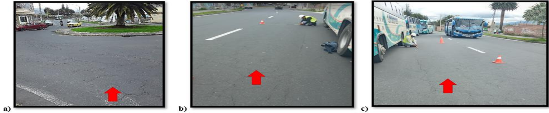
Figura 104: Vía colectora Olmedo con diferentes fallas: a, b, c) Piel de cocodrilo baja severidad.
