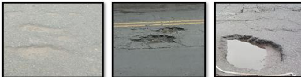
Figura 35: Falla tipo hueco de severidad baja, media, alta.
