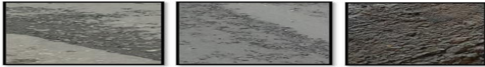
Figura 41: Falla tipo meteorización / desprendimiento de agregados de severidad baja, media, alta.
