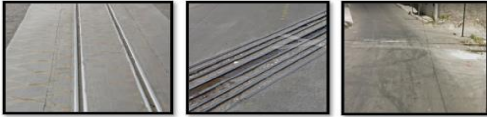
Figura 36: Falla tipo cruce de vía férrea de severidad baja, media, alta.
