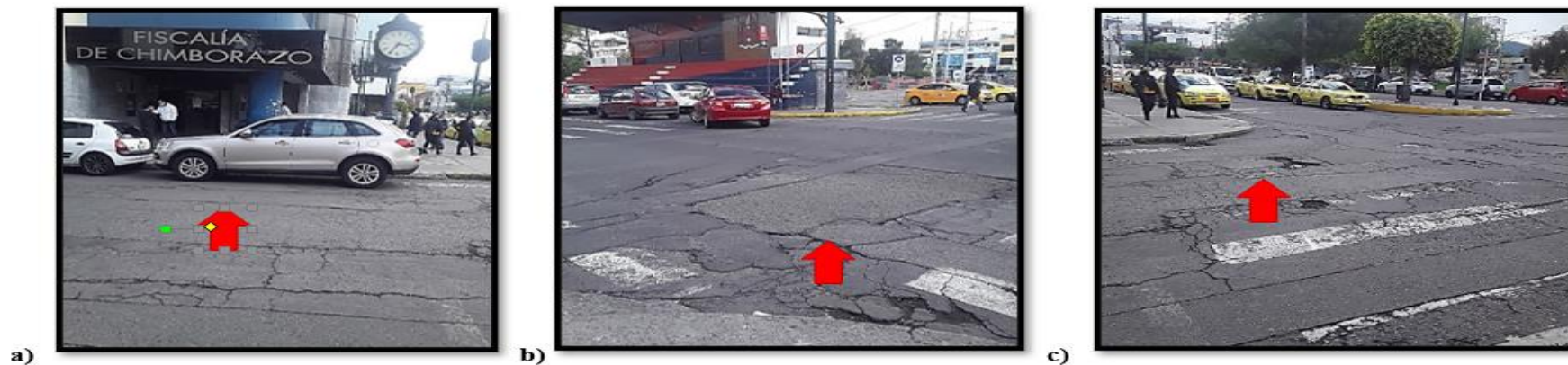
Figura 103: Vía colectora José Veloz con diferentes fallas, a) Agrietamiento en bloque severidad alta, b) Parche, agrietamiento en bloque, piel de cocodrilo severidad alta, c) Huevo, agrietamiento en bloque, piel de cocodrilo severidad alta.
