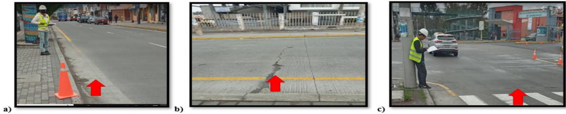
Figura 107: Vía colectora Anillo Vial (Media Luna - Entrada a ESPOCH) con diferentes fallas: a,c) Sello de Junta de severidad baja, b) Grieta de durabilidad “D”.
