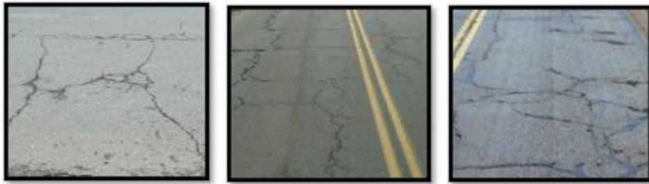
Figura 25: Falla tipo grietas en bloque de severidad baja, media, alta
