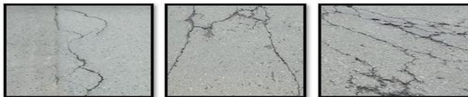
Figura 39: Falla tipo grieta parabólica de severidad baja, media, alta.
