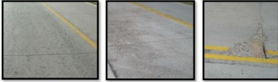
Figura 18: Falla tipo, Mapa de Grietas, Craquelado severidad baja, media, alta.
