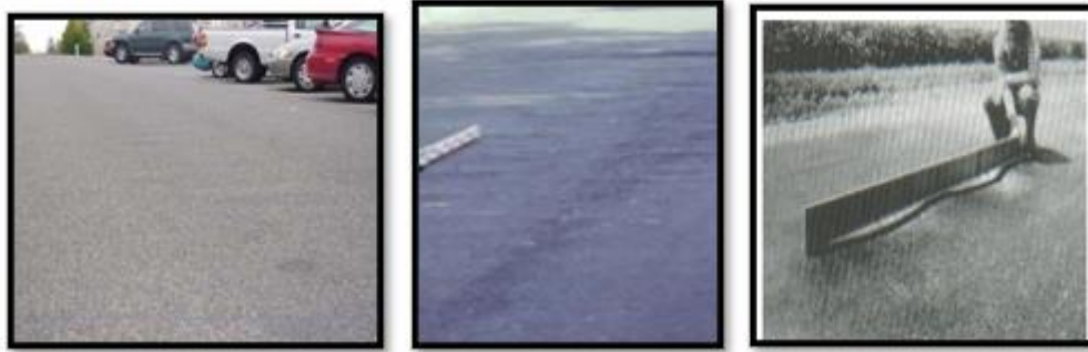
Figura 27: Falla tipo corrugación de severidad baja, media, alta Fuente: (Vásquez, 2002)
