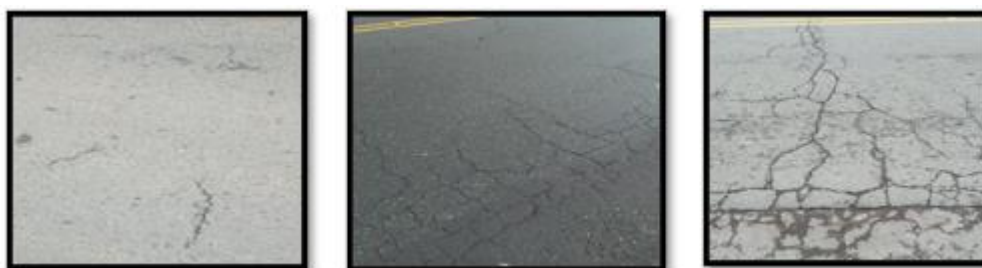
Figura 23: Falla piel de cocodrilo severidad baja, media, alta
