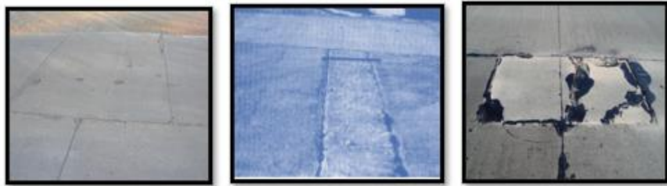
Figura 12: Falla tipo parche pequeño de severidad baja, media, alta.
