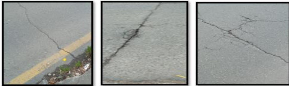
Figura 32: Falla tipo grietas longitudinales y transversales de severidad baja, medio, alta.
