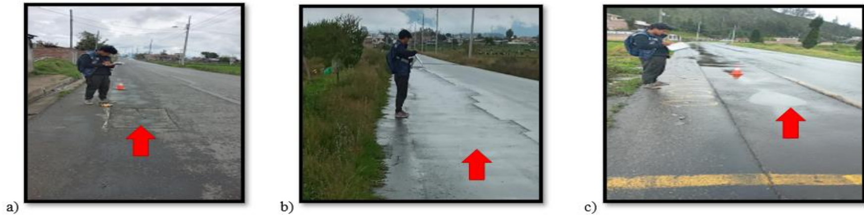
Figura 100: Vía arterial Licto - Riobamba con diferentes fallas, a) Parche de severidad media, b) Parche de severidad baja, c) hundimiento de severidad media.
