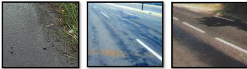
Figura 24: Falla tipo exudación de severidad baja, media, alta.
