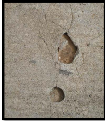
Figura 14: Falla tipo desprendimiento.
