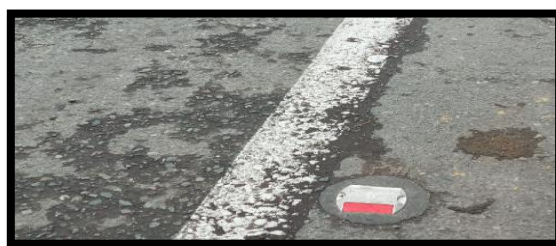
Figura 34: Falla tipo pulimientos de agregados
