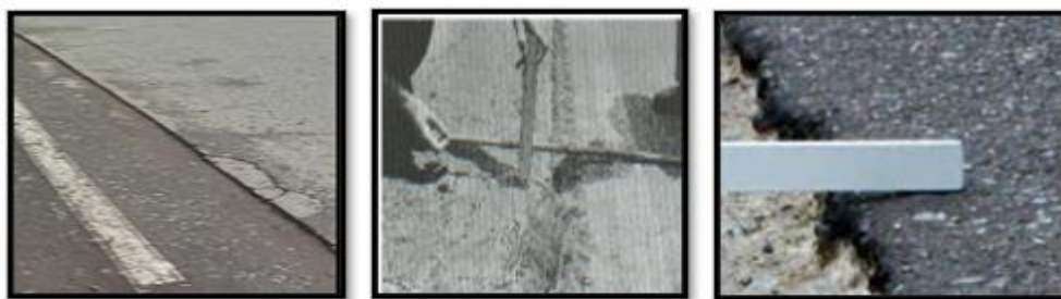
Figura 31: Falla tipo desnivel de carril severidad baja, medio, alta. (Calo, 2016)
