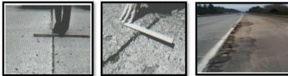
Figura 7: Falla tipo escala de severidad baja, media, alta.
