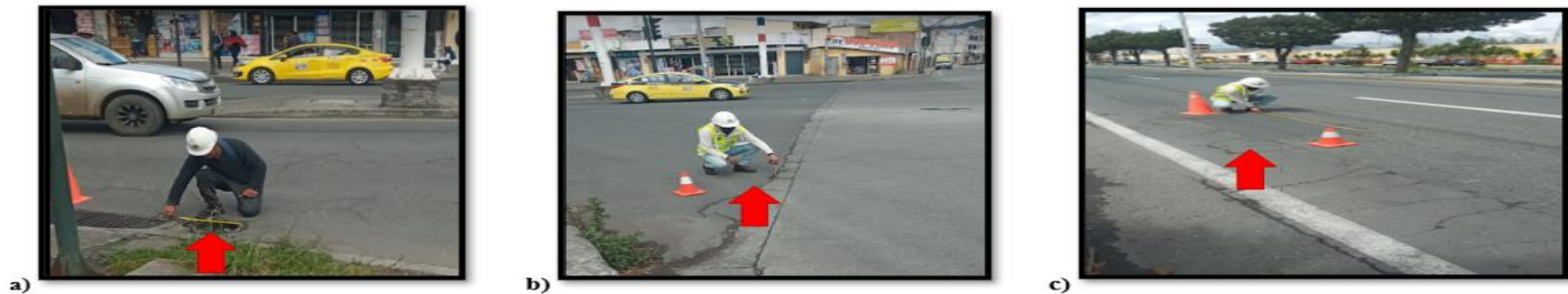
Figura 101: Vía arterial Leopoldo Freire con diferentes fallas, a) Hueco de severidad baja, b) Grieta longitudinal severidad media, c) Parche y piel de cocodrilo severidad media.
