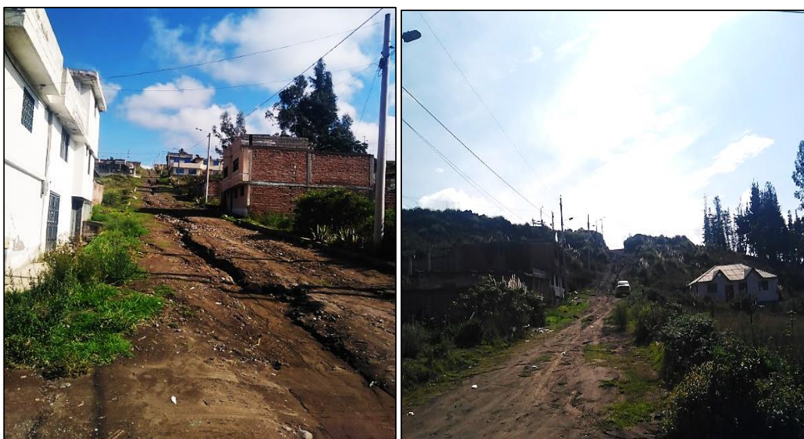
Ilustración 42: Vías en mal estado e inaccesibles por la erosión - Barrio Santa Anita. Fuente: Elaboración propia, 2022
