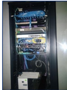
Fig. 5 Equipos-cuarto frio1 Fuente: Elaboración Propia
