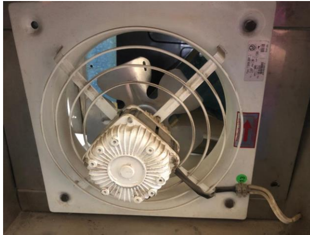
Figura 5. Desmontaje del motor
