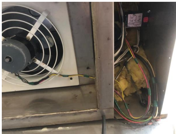
Figura 8. Instalaciones del motor
