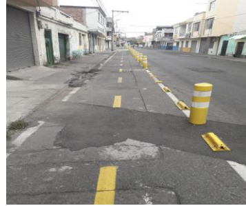
Ilustración 29. Bacheo. Ciclovía Transversal
