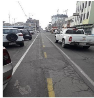
Ilustración 31. Piel de cocodrilo y Bacheo. Ciclovía Longitudinal
