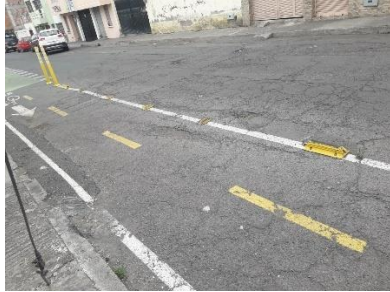
Ilustración 28. Falla de cocodrilo. Ciclovía Transversal
