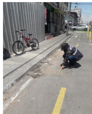
Ilustración 33. Medición de las fallas de la ciclovía
