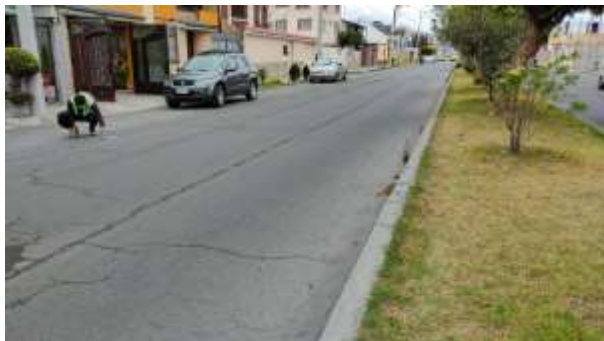
Foto 12 Medición de las fallas de la Av. 11 de Noviembre
