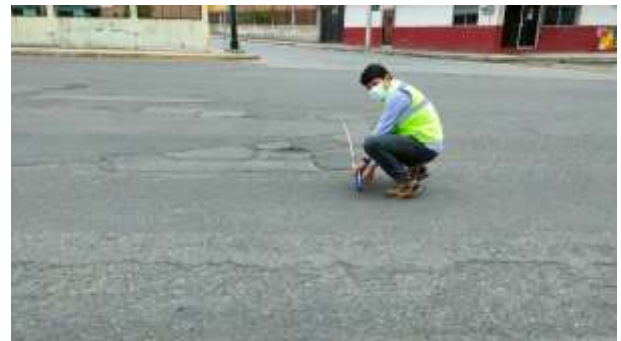
Foto 13 Medición de las fallas de la Av. Monseñor Leónidas Proaño
