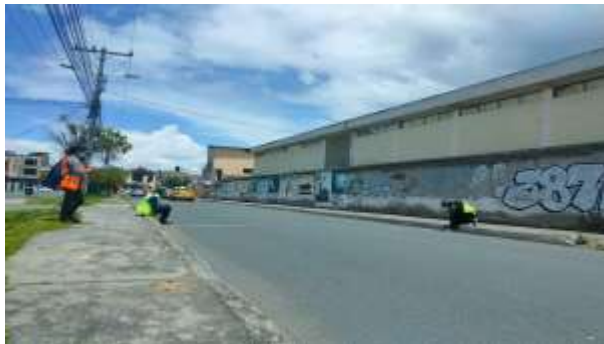
Foto 10 Medición de las fallas de la Av. Atahualpa
