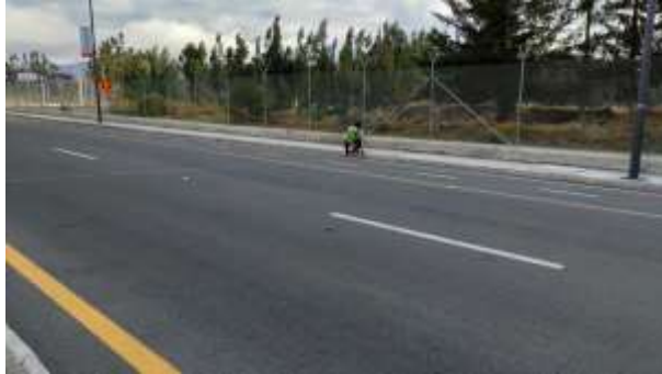
Foto 8 Medición de las fallas de la Av. Bicentenario
