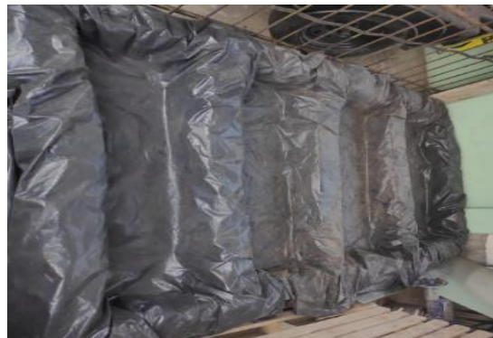
Imagen 28. Cubetos de recolección de infiltraciones
