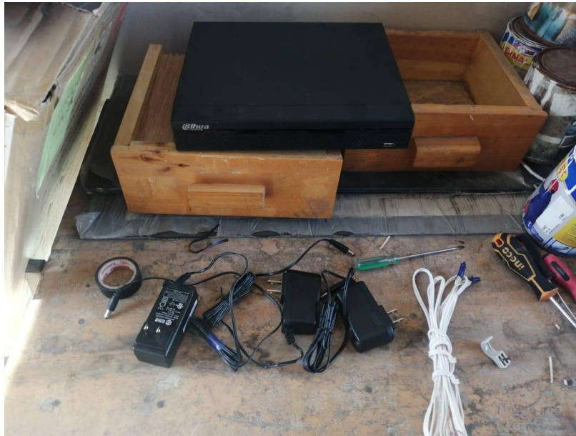
Ilustración 23: Instalación del DVR. Elaborado por: Calle C, Valdiviezo A.
