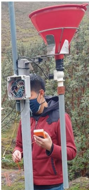
Figura 4. Pluviómetro Estación Yanarumi
