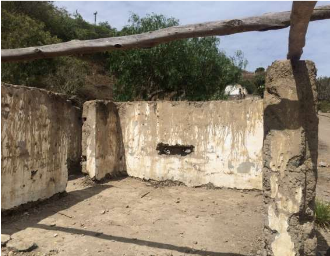
Figura 19. Evidencia del deterioro de las construcciones en La Gerencia de Ferrocarriles, Pistishí. Fuente: Cevallos & Ponce, 2021.
