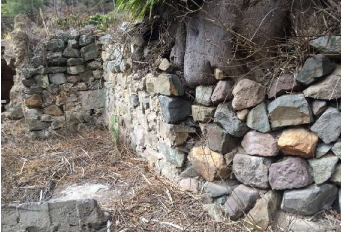
Figura 4. Material de construcción deteriorado. Fuente: Cevallos & Ponce, 2021
