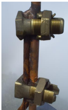
FIGURA 5.31.U Cable 2 AWG a pararrayos. 173
