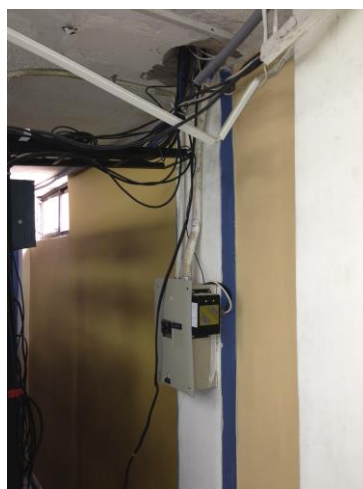
FIGURA 5.31.K Caja eléctrica master. 165
