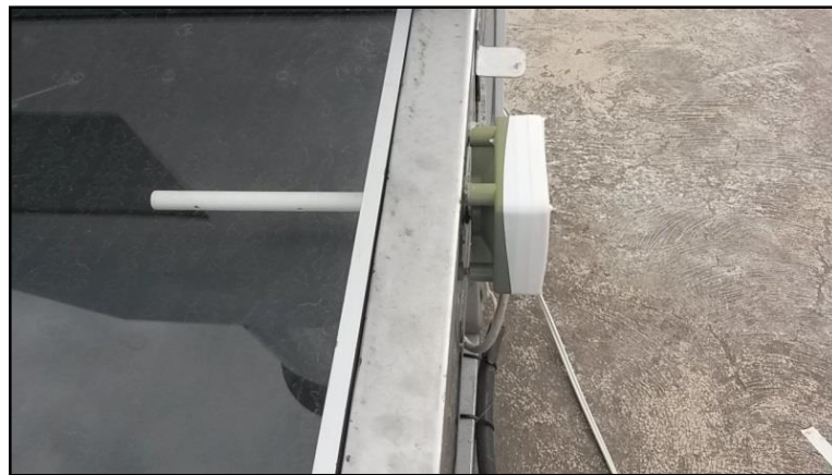
Figura 102. Sensor de velocidad de viento de la cámara de secado.
