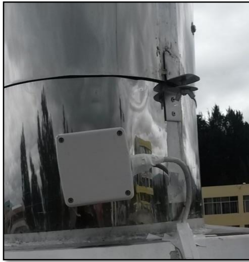
Figura 103. Sensor de velocidad de viento de la chimenea.
