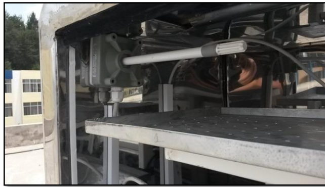
Figura 99. Sensor de Humedad Temperatura de la cámara de secado.
