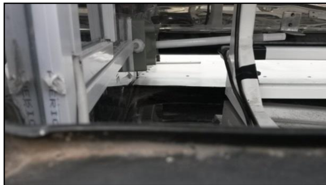
Figura 98. Sensor de Humedad Temperatura del colector
