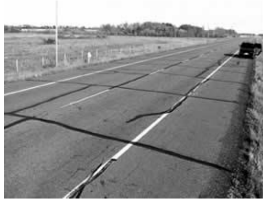
Figura 3. Ejemplo de agrietamiento por temperatura (Fuente: ASTM.org)
