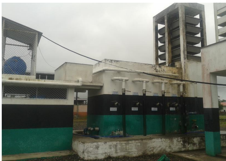
Figura 1: Planta de tratamiento Barrio Alborada.
