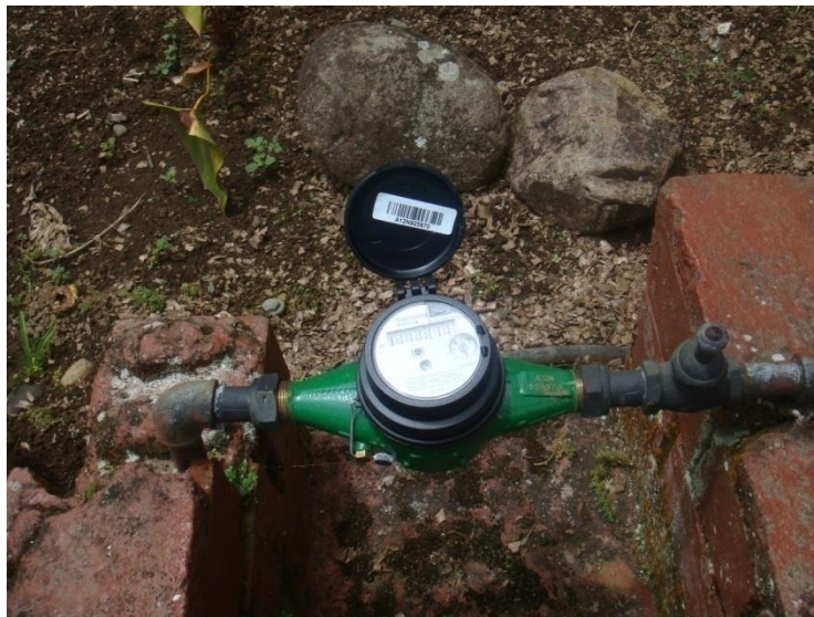
- Fotografía N° 11 Medidor en buenas condiciones.
