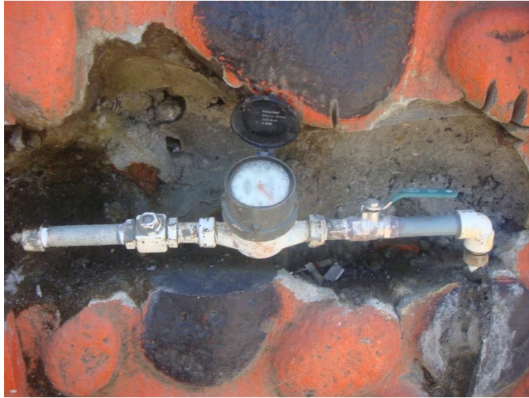
- Fotografía N° 14 Medidores en pésimas condiciones
