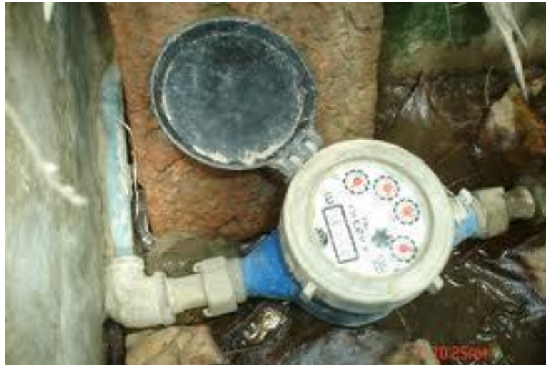
- Fotografía N° 13 Medidores en muy malas condiciones.
