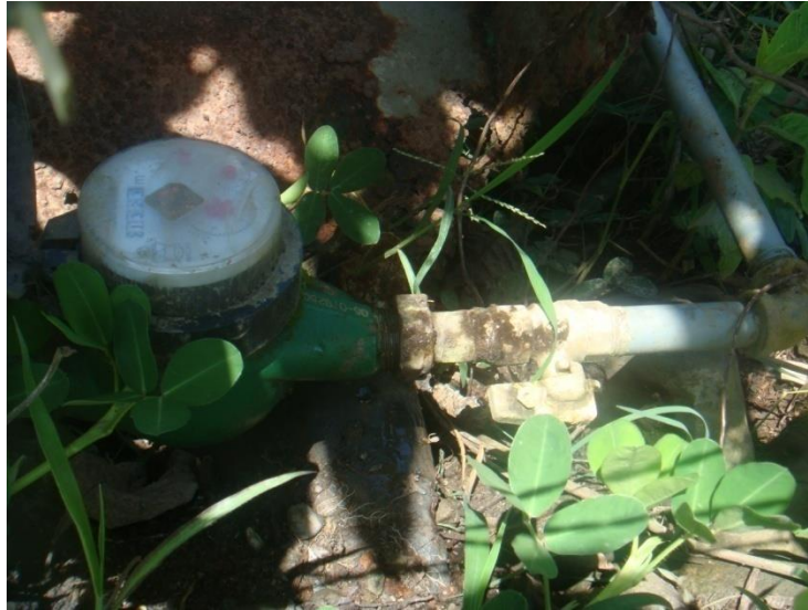
- Fotografía N° 12 Medidores en malas condiciones.
