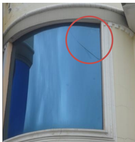
Figura 14. Daños no Estructurales, agrietamiento de paneles de vidrio.
