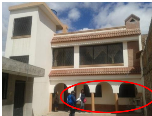
Figura 7. Vivienda con columnas cortas en la primera planta.
