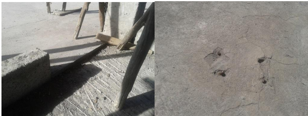
Figura 12. Problemas ocultos más comunes en la construcción.
