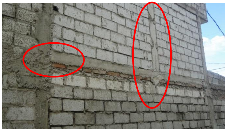
Figura 10. Discontinuidad de elementos estructurales.
