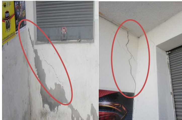
Figura 15. Las fallas debidas a corte, Barrio Liribamba.
