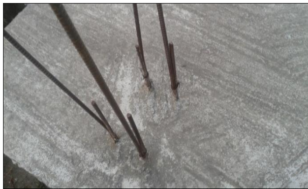
Figura 23. Acero visible y oxidado en columnas.
