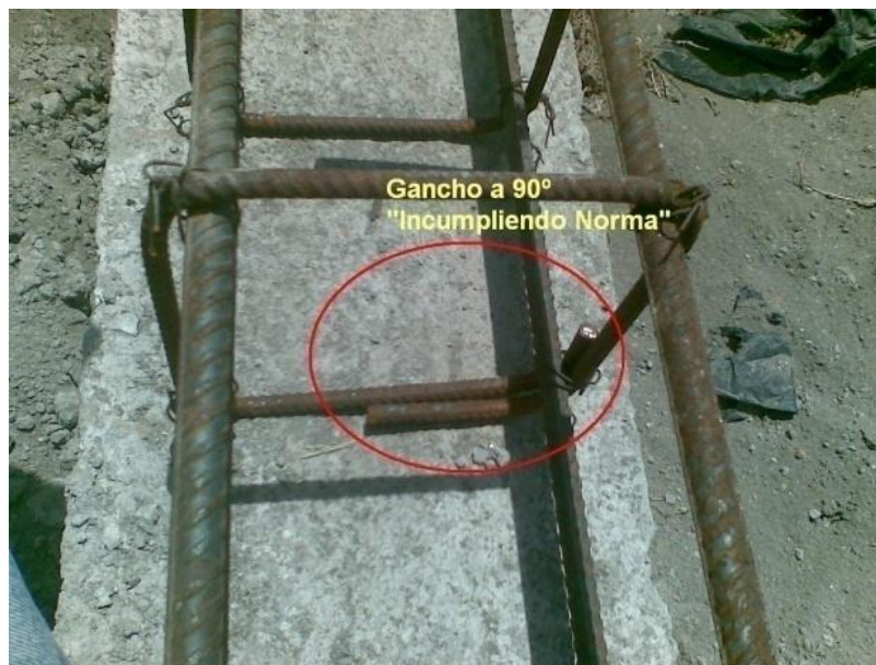
Figura 10. Barrio La Florida, Refuerzo Transversal mal construido. (N 9814012; E 751114; altura 2792m.s.n.m.) ELABORADO POR: JP - MT
