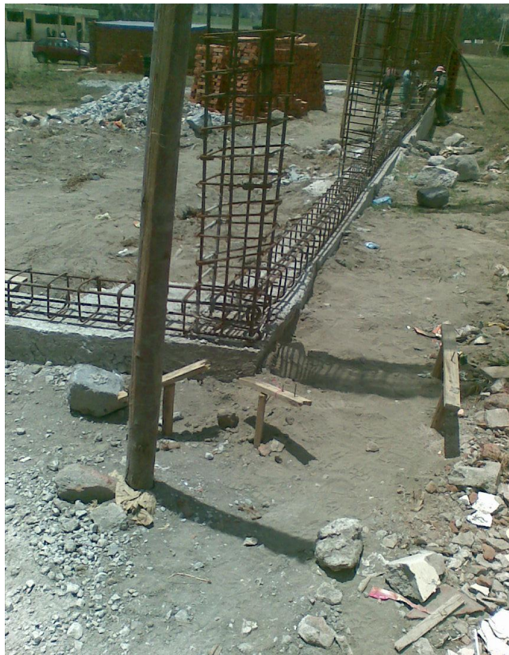
Figura 12. Barrio La Florida, estribos con ganchos a 90° (N 9814012; E 751114; altura 2792m.s.n.m.) ELABORADO POR: JP - MT
