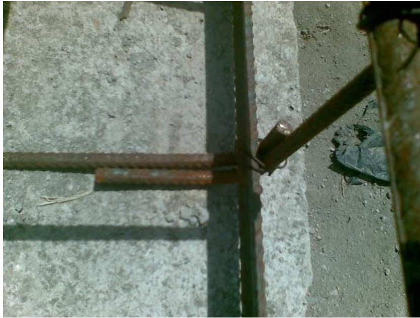
Figura 11. Barrio La Florida, Refuerzo Transversal mal construido. (N 9814012; E 751114; altura 2792m.s.n.m.) ELABORADO POR: JP - MT
