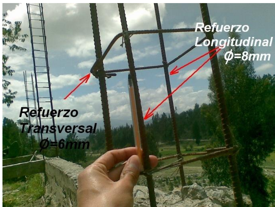
Figura 9. Barrio La Florida, Refuerzos Incumpliendo Normas de construcción. (N 9814028; E 761130; altura 2758m.s.n.m.) ELABORADO POR: JP - MT
