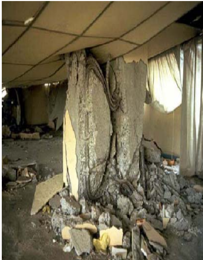
Figura 16. Desintegración total de columna de planta baja
