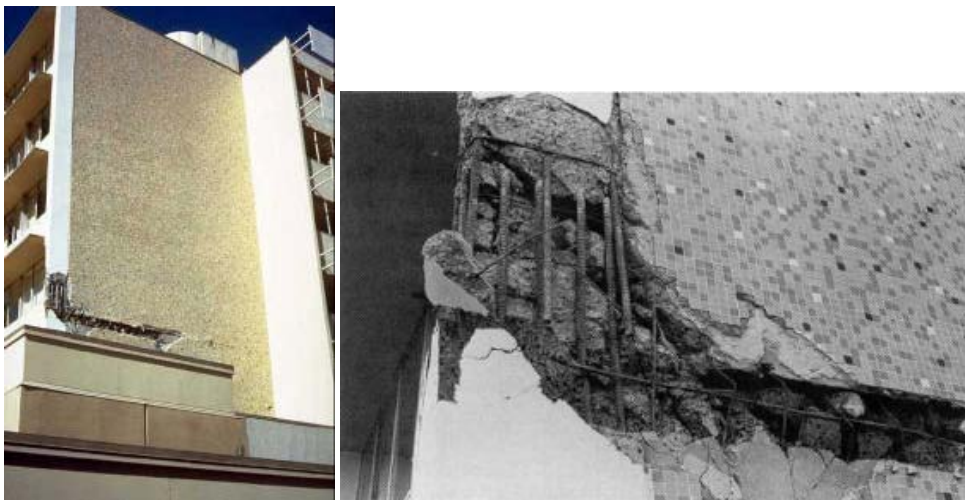
Figura 21. Grieta y desconchamiento del concreto en muro de cortante y acercamiento del daño del edificio del Hospital Holy Cross
