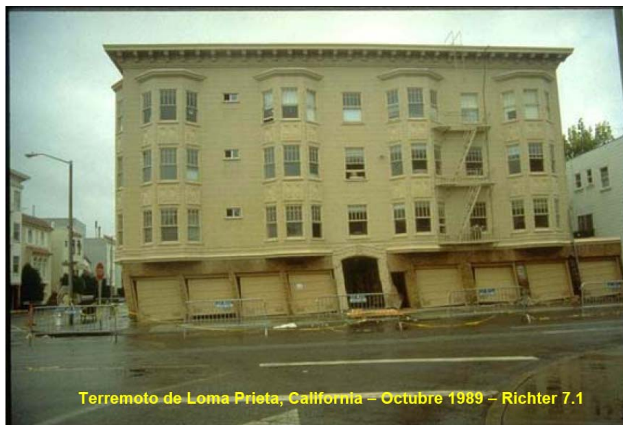
Figura 6. Falla en planta baja por piso suave FUENTE. Terremoto de Loma Prieta, California – Octubre 1989
