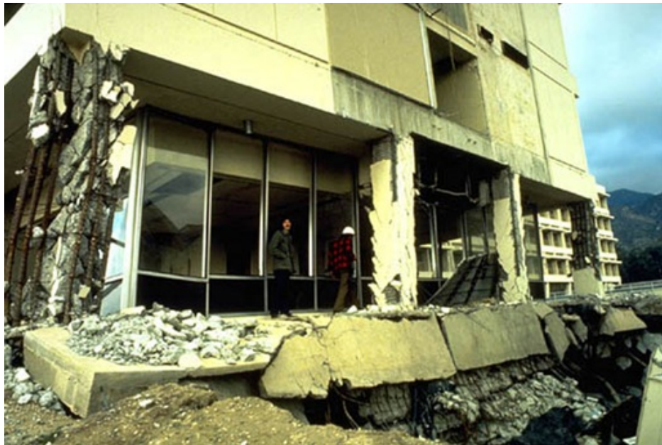
Figura 26. Falla de un edificio a base de losas planas por punzonamiento de losa
