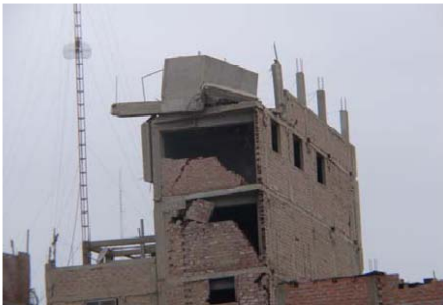
Figura 5. Concentraciones de masa, tales como estanques de agua en el techo de edificaciones FUENTE. Artículo del sismo de Perú de 2007
