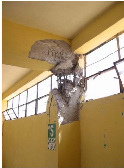
Figura 18. Falla en unión viga-columna por escasez de anclaje en la conexión de la columna con el sistema de piso
