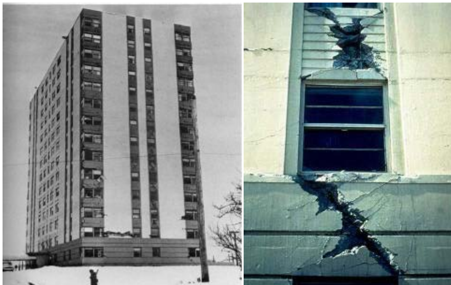
Figura 22 A. Vista y acercamiento de daños con falla en X de vigas de acoplamiento en muros de cortante
