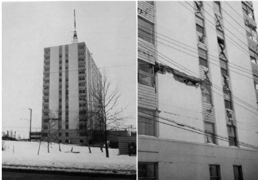
Figura 22. Daños en fachada norte del edificio Mt. McKinley
