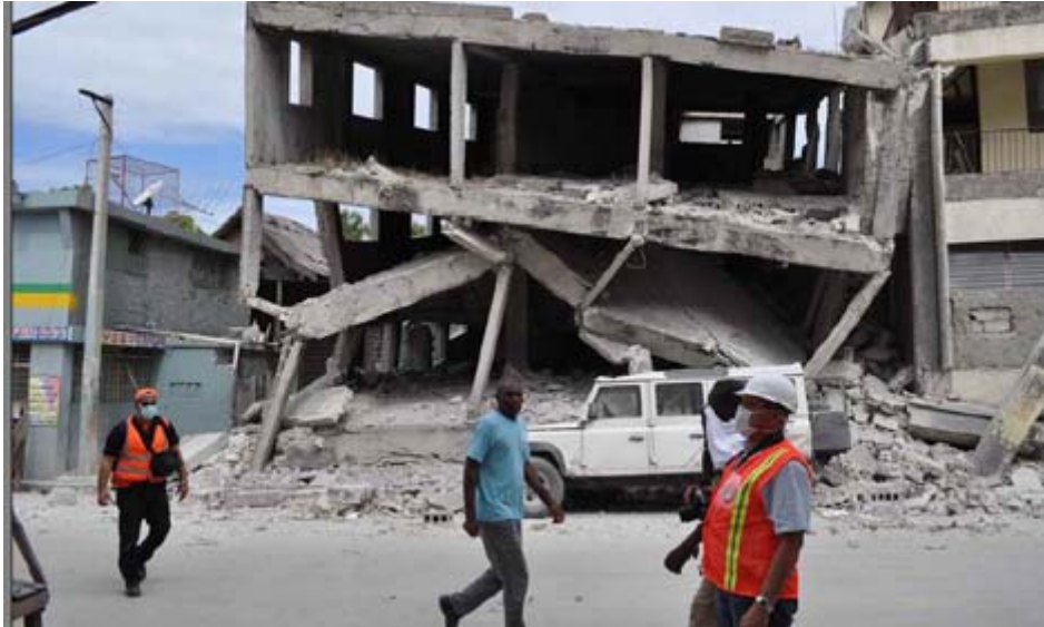
Figura 8. Colapso estructural debido a la discontinuidad de elementos verticales
