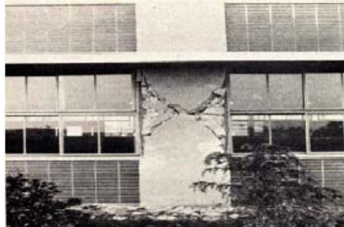
Figura 31. Falla típica por cortante en columnas cortas.
