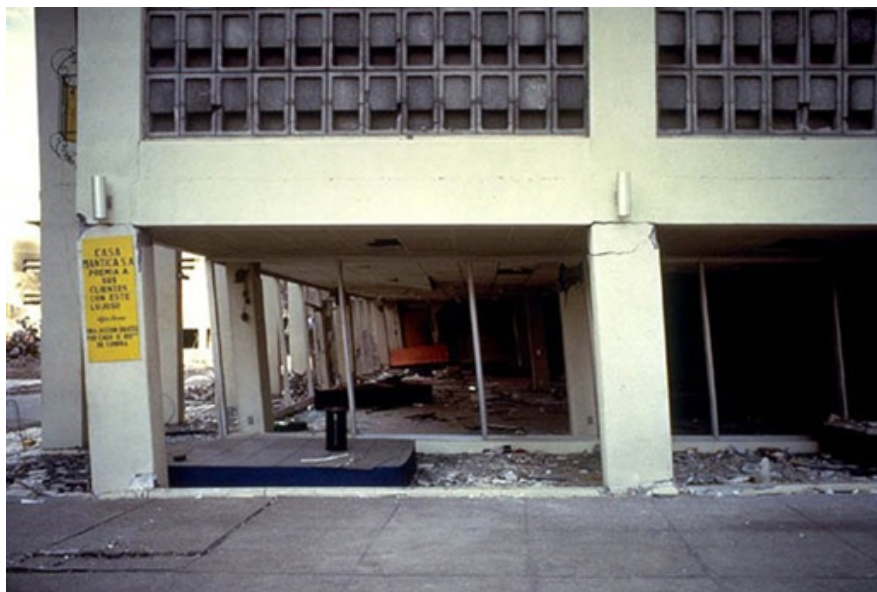
Figura 27. Falla en planta débil de edificio
