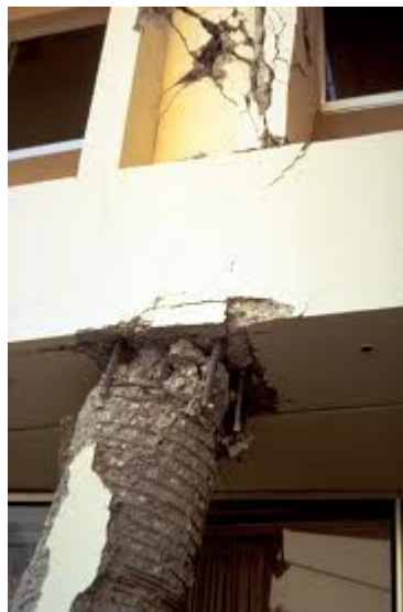
Figura 15. Falla por tensión diagonal en columnas con estribos
