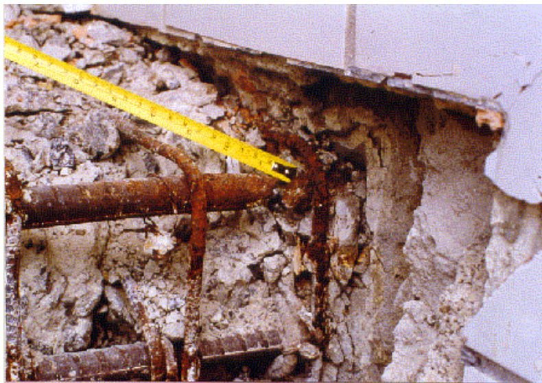
Figura 19. Falla por deficiente adherencia en conexión viga-columna y croquis de anclaje a 90° para el desarrollo de la fluencia requerida ante sollicitaciones cíclicas propias de la acción sísmica.
