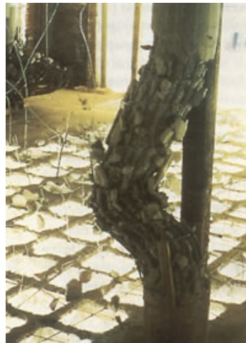
Figura 28. Columna de esquina severamente dañada
