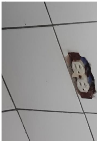
Toma corrientes rotos.
