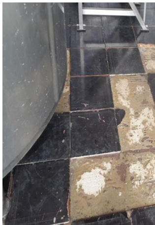
Piso de la planta en mal estado.
