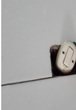
Interruptores en mal estado.
