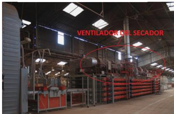
Figura 13. Ventilador de secadero
