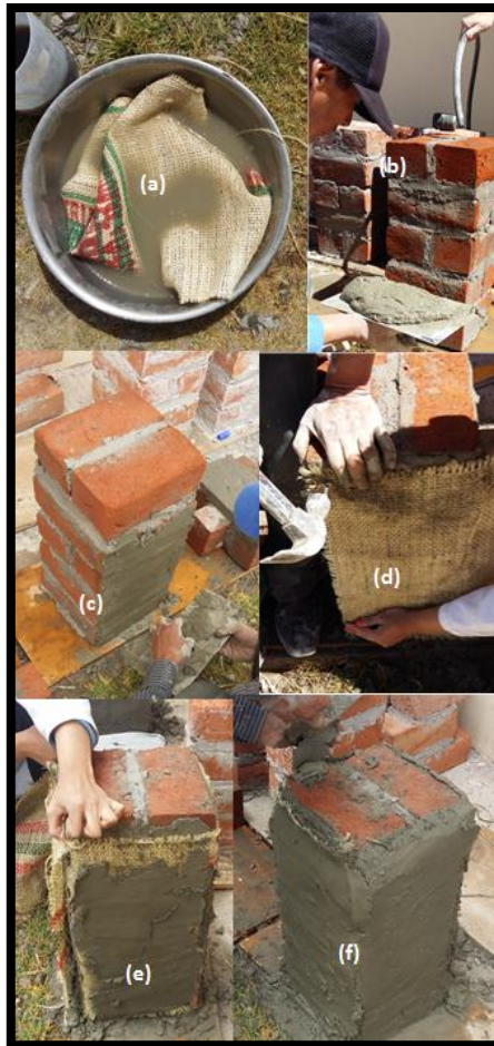
Figura 76. Procedimiento para el refuerzo de columnas: (a) humedecer muestras de cabuya, (b) humedecer las columnas (c) colocación de mortero (d) colocación de la fibra, (e) segunda capa de mortero y (f) última capa de mortero
