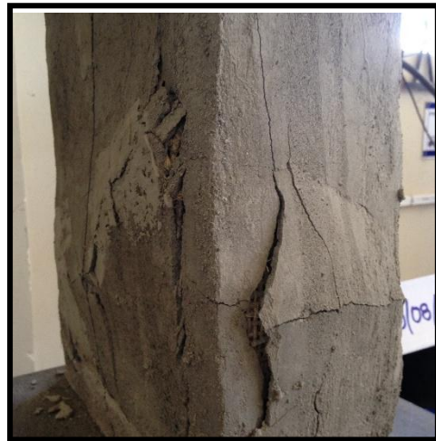
Falla pila C/R 4
