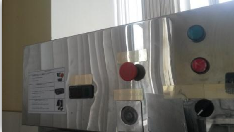
Figura 9.- Etiquetas circuito de mando.
