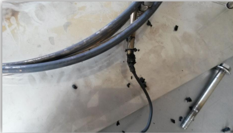
Figura 15.- Desgaste en conexiones de los resistores.
