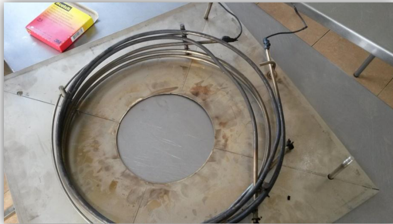
Figura 17.- Aislamiento de los terminales de conexión.
