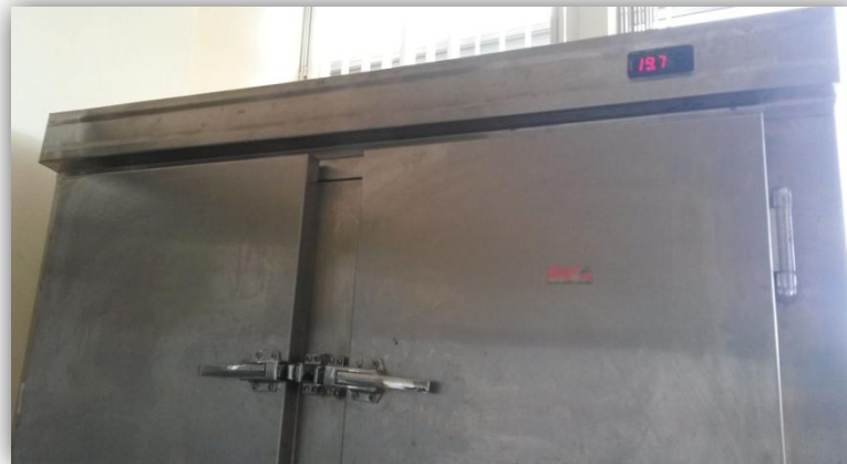
Figura 26.- Refrigerador 1 en funcionamiento.
