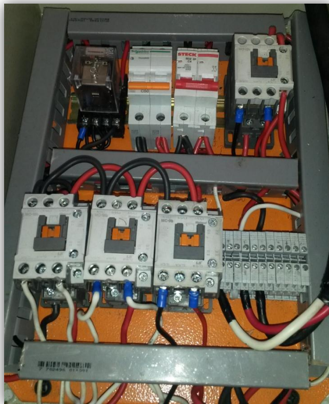
Figura 6.- Tablero de circuito de control realizado mejoras.
