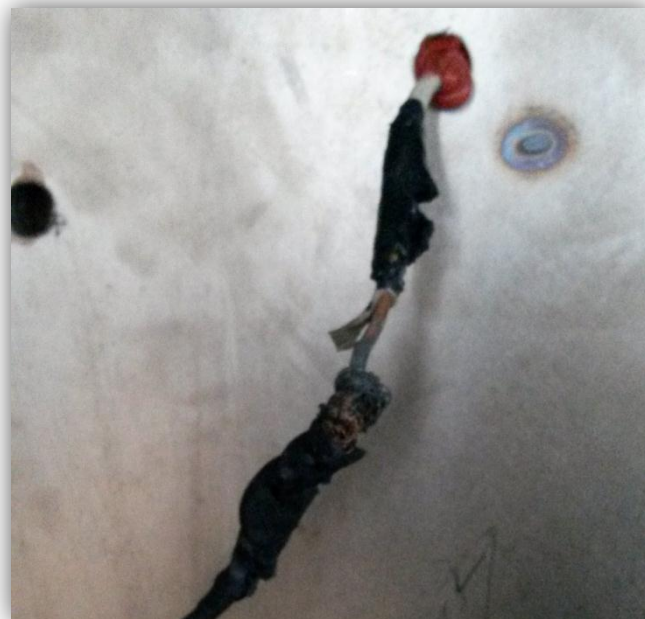
Figura 14.- Mal estado de las conexiones del resistor del horno. Fuente: Autores.
