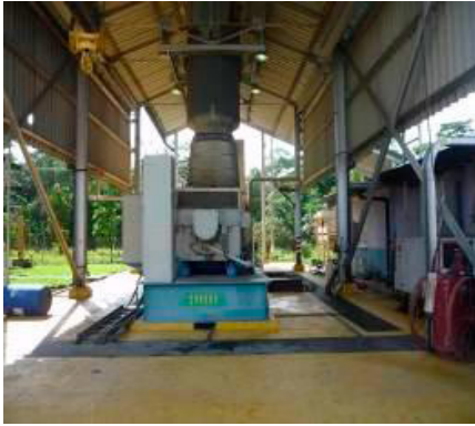
ÁREA DE TURBINAS
