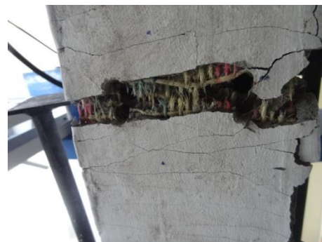
Tejido de cabuya roto- sistema de anclaje
