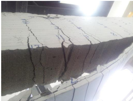
Fisuras después del desprendimiento del material compuesto
