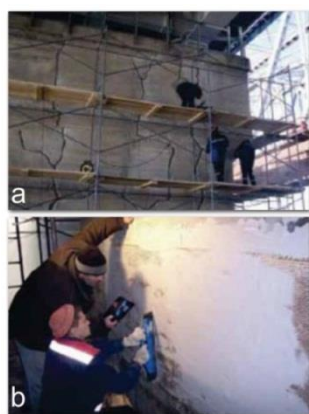
Figura 24. a) Reparación de grietas previa aplicación del sistema FRCM, b). Aplicación de la capa de terminación con mortero impermeabilizante. FUENTE: Universidad de Chile-Pablo Sandoval.
