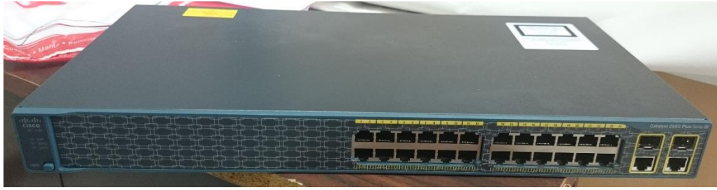
Figura 23. Switch Cisco Catalyst 2960, configuración puertos. Fuente: Autores
