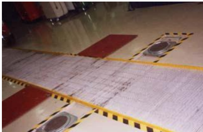
Ilustración 26. Ejemplo foso protegido con cubierta Fuente: https://www.sprl.upv.es/msmecanico1.htm#p11
